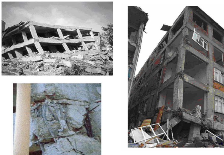
شکل-۱) خرابی در اتصالات ساختمانهای بتن مسلح در زلزله ۱۹۹۹ ترکیه
