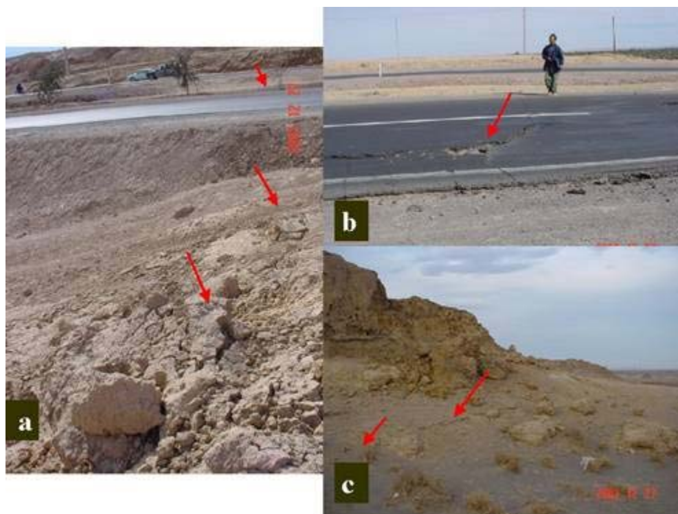
شکل -4: گسیختگی های سطحی در راستای گسل بم
