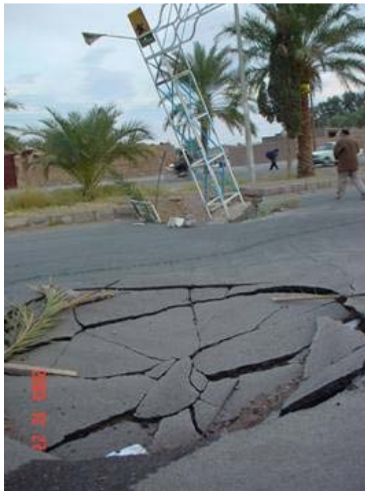
شکل-5: فروچاله ایجاد شده در بروات در نزدیک گسل بم
