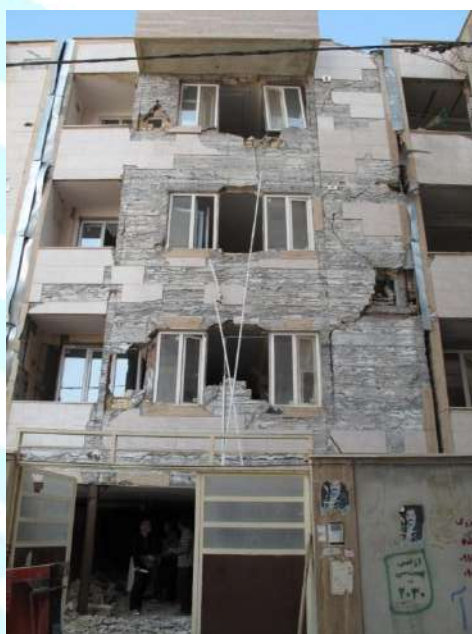
شکل ۸-۳۴- فروریزش سنگ‌نما و دیوارهای جدا کننده بین پنجره‌ها به دلیل عدم مهار مناسب
