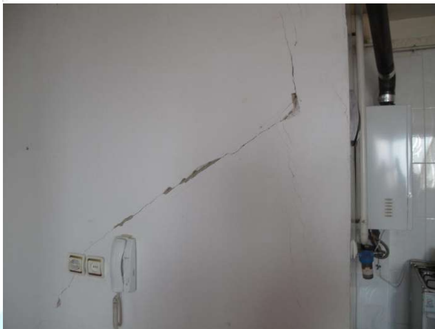
شکل ۸-۴۰- ترک جزئی در دیوار جداکننده
