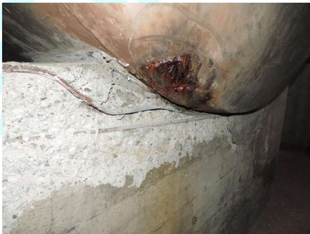
شکل ۱۰-۳۹- چرخش مخزن و آسیب وارده به تکیه‌گاه آن در تصفیه‌خانه آب سرپل ذهاب
