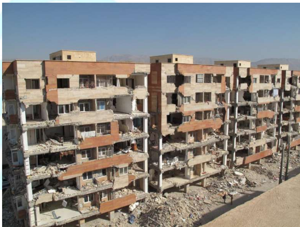
شکل ۸-۱۱- فروریزش نما و دیوارهای خارجی در راستای شرقی-غربی
