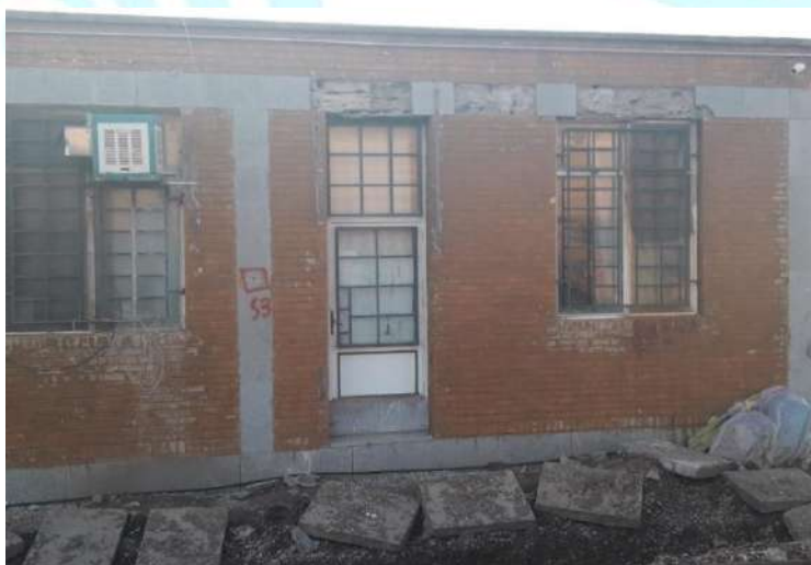
شکل ۱۲-۸۹- تخریب بخشی از نمای سنگی
