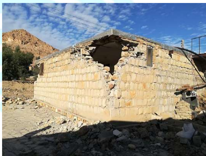
شکل ۷-۳- شکست کنج در تقاطع دیوارهای سازه‌ای ساختمان‌های بنایی بدون کلاف
