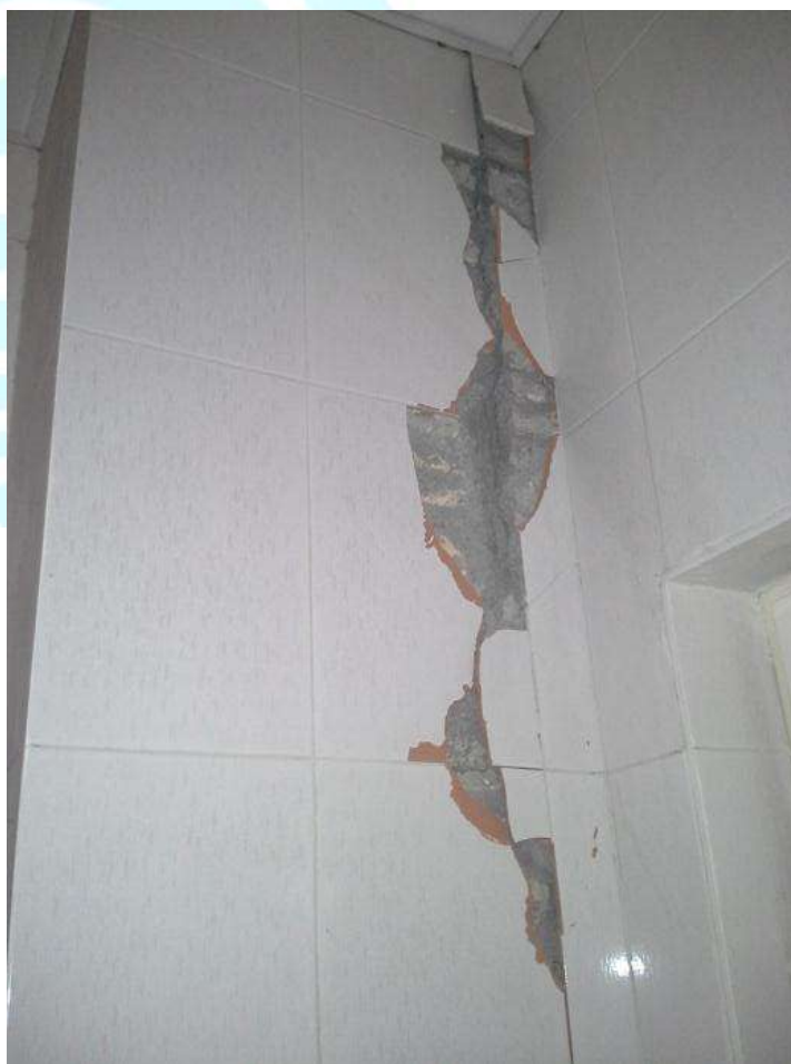
شکل ۱۲-۴۷- ترک خوردگی در دیوارهای بخش زایمان و ریزش کاشی‌ها
