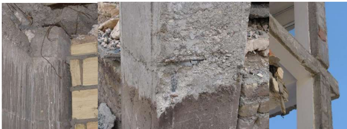
شکل ۵-۲۲- عدم رعایت ضوابط قالب‌بندی و رواداری‌ها
