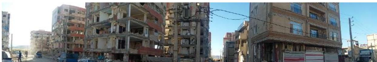
شکل ۱۴-۱۱- نمونه‌ای از آسیب‌های ایجاد شده به اعضای غیرسازه‌ای به ساختمان‌های شهرک شهید شیروودی
