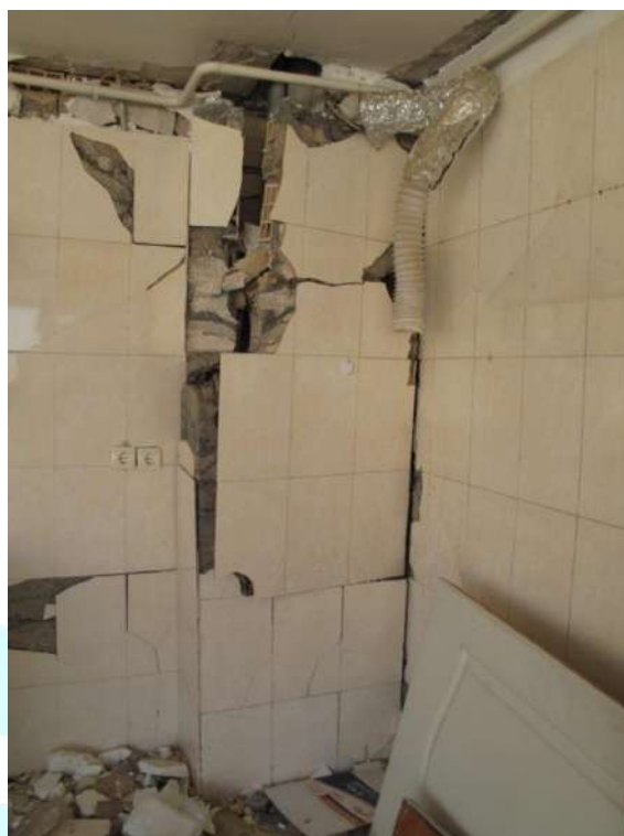
شکل ۸-۱۲- شکست بخش نازک‌کاری و دیوارهای آشپزخانه
