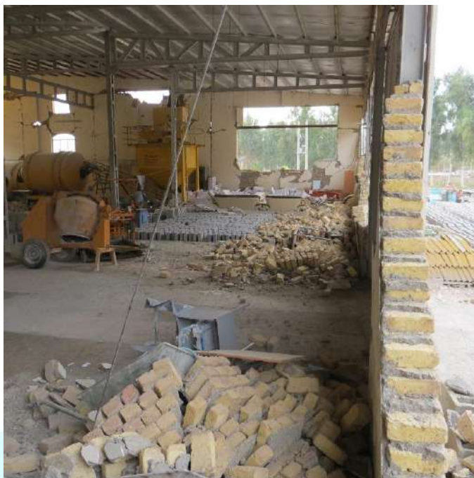
شکل ۱۱-۱۰- تخریب دیوارهای جانبی به دلیل عدم مهار آنها به سازه اصلی در کارگاه تولید قطعات بتنی شهرک صنعتی سرپل ذهاب
