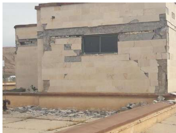
شکل ۱۲-۵۲- ترک‌خوردگی اعضای سازه‌ای در اتاقک‌های هواساز
