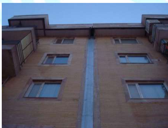
شکل ۸-۱۴- سلامت ورقه فلزی بین دو ساختمان در مسکن مهر فرهنگیان
