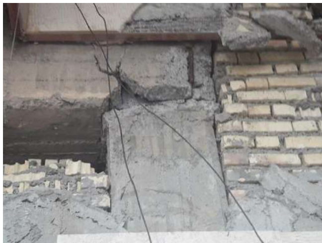
شکل ۱۲-۱۴- عدم امتداد و مهار مناسب میلگرد در ستون و آسیب در محل اتصال
