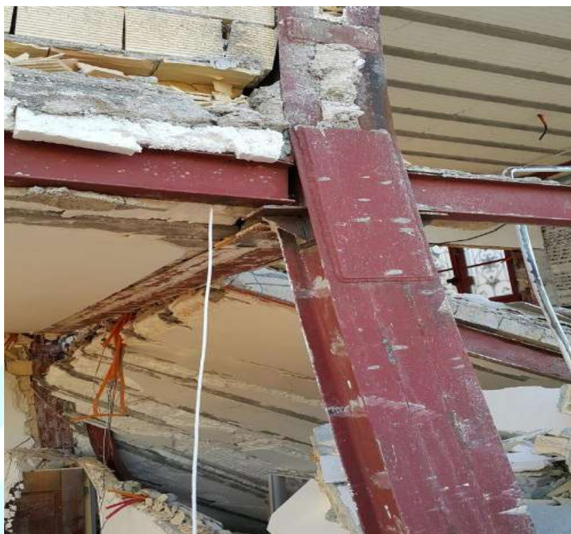
شکل ۹-۱۷- ریزش سقف طبقه همکف در ساختمان شاهد
