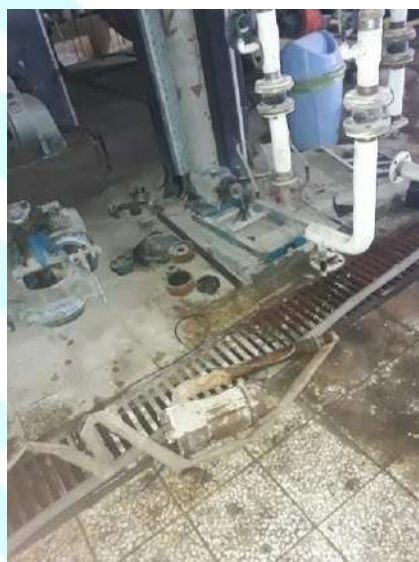
شکل ۱۲-۶۰- آسیب وارده به تجهیزات مکانیکی
