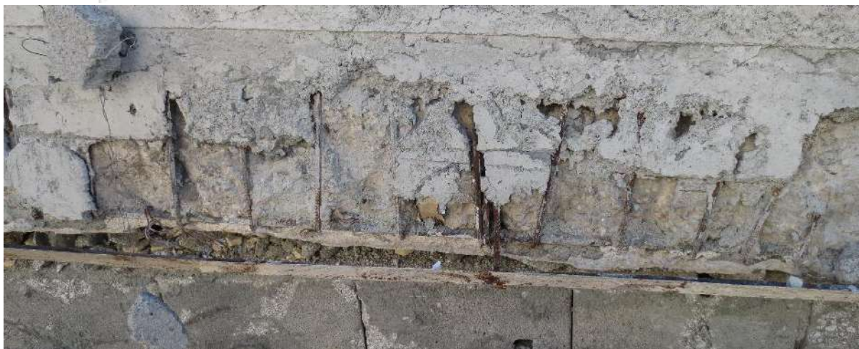
شکل ۸-۵۶- مشاهده کیفیت نامطلوب بتن‌ریزی تیرها پس از ریزش نمای ساختمان
