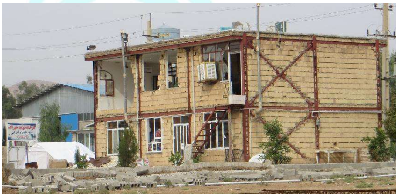
شکل ۱۱-۱۱- آسیب جزئی ساختمان فلزی با ارتفاع و تعداد طبقات مشابه در فاصله حدود ۵۰ متری از ساختمان شرکت ساروج
