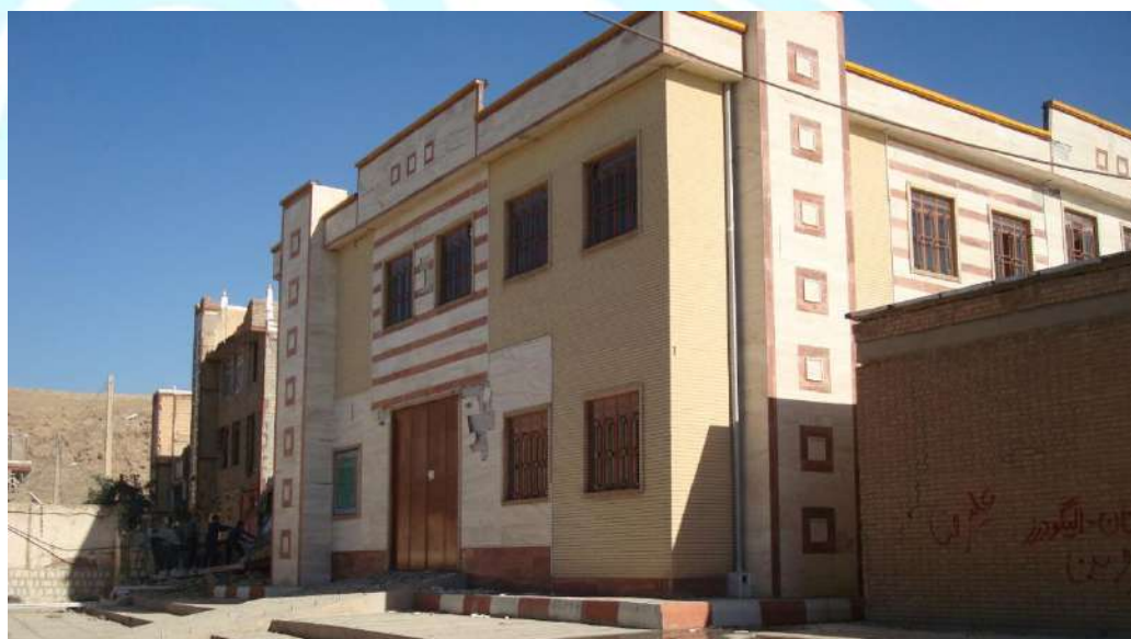
شکل ۱۳-۱۳- هنرستان پسرانه البرز و برخی آسیب‌های ایجاد شده در نما و دیوارها
