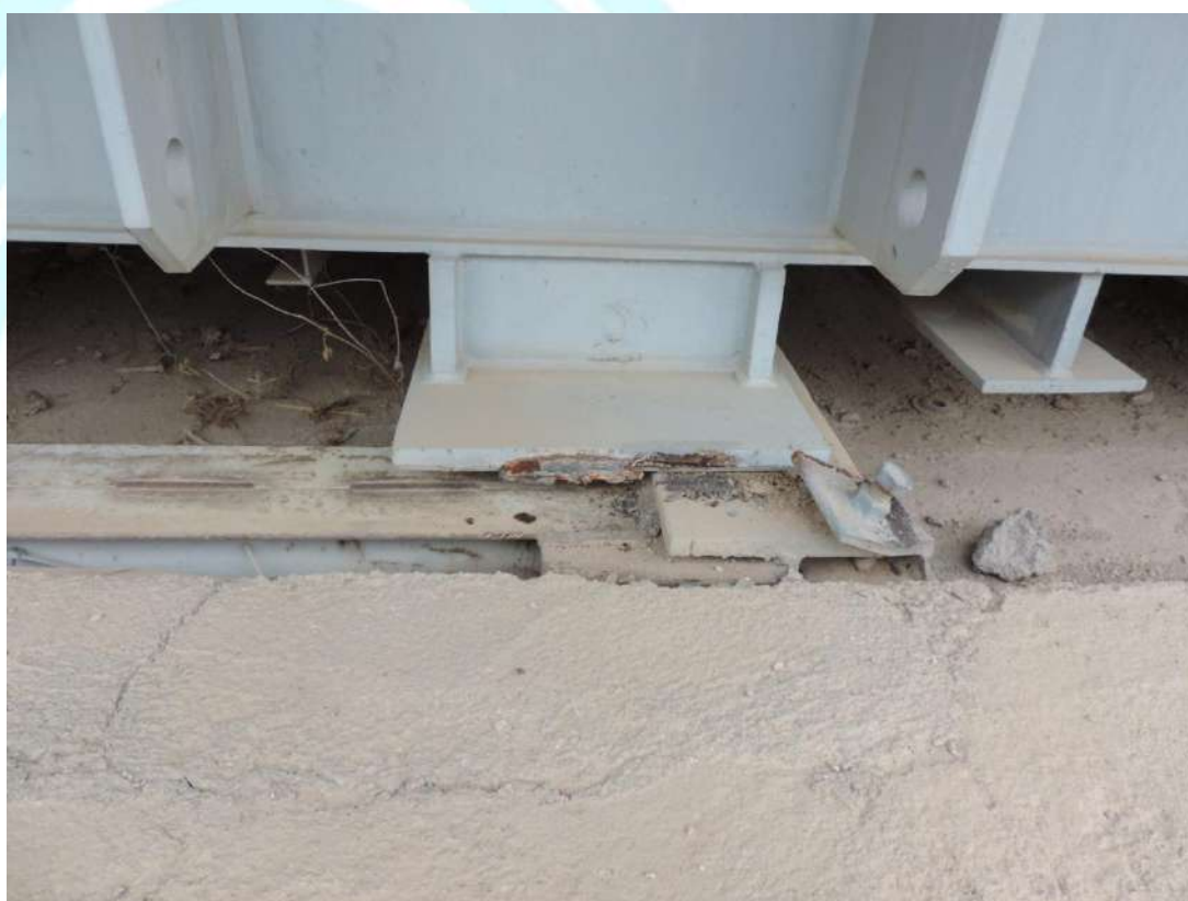
شکل ۱۰-۳۰- لغزش ترانس پست ۲۳۰kV سرپل ذهاب
