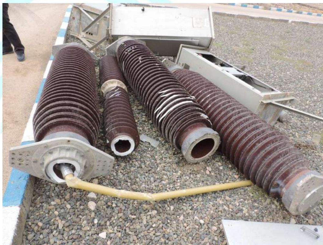
شکل ۱۰-۲۸- سقوط و شکستن تجهیزات پست ۲۳۰kV سرپل ذهاب
