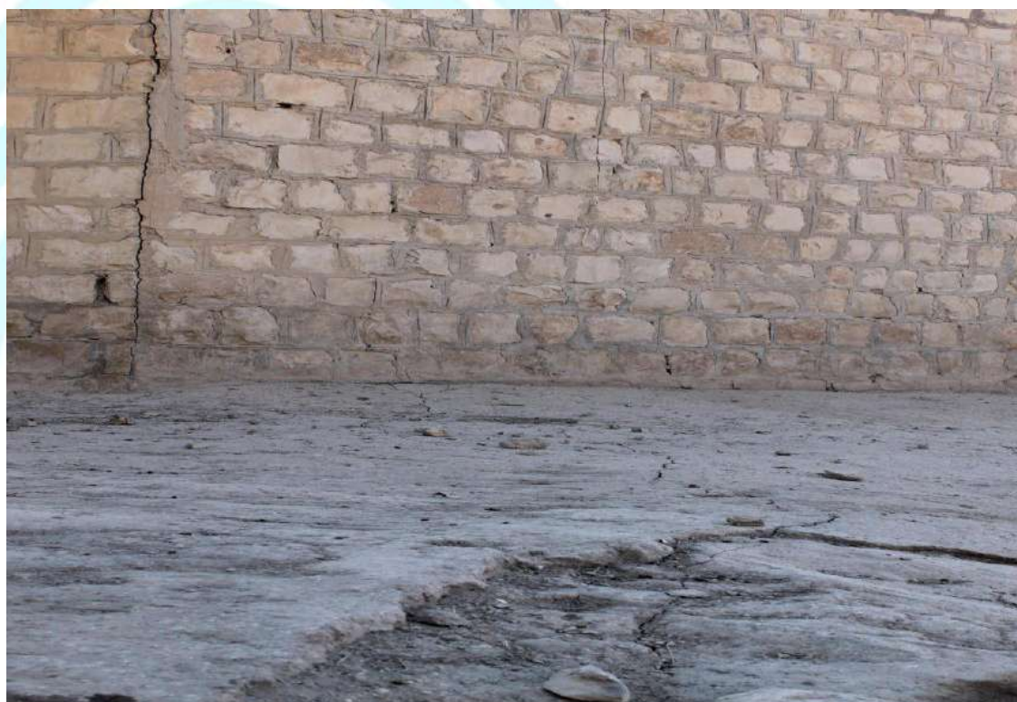
شکل ۱۰-۴- ترک‌هایی در بستر رودخانه که کف‌سازی بتنی شده در زیر پل فلزی دو دهانه
