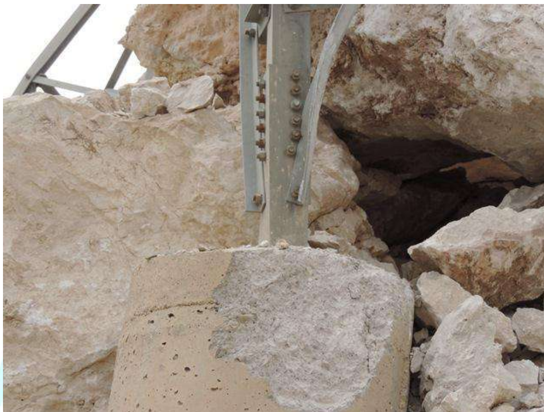
شکل ۱۰-۱۷- آسیب دیدن فونداسیون و اجزای دکل سقوط دکل خط انتقال بخش خصوصی بر اثر ریزش کوه
