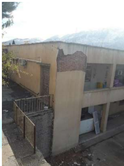
شکل ۱۲-۸۱- تخریب بخشی از نمای غربی بیمارستان
