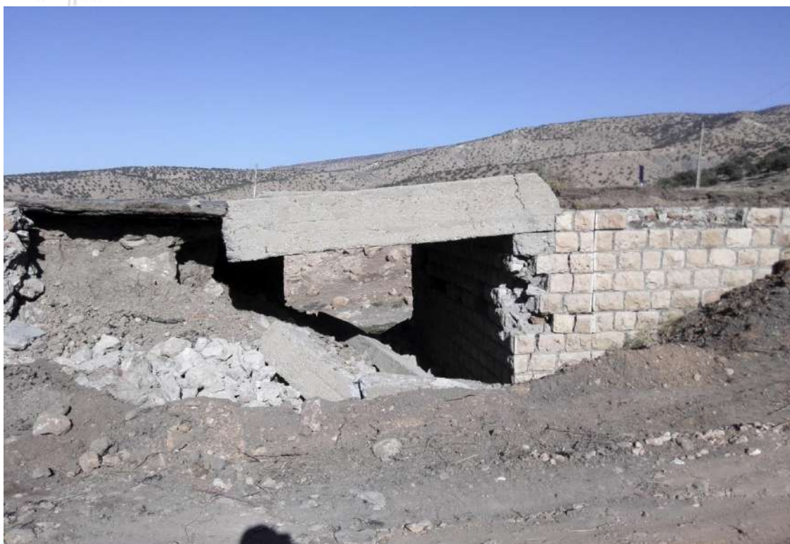
شکل ۱۰-۹- فرو ریختن کوله پل با دهانه ۴ متری در محور تازه‌آباد به سرپل ذهاب
