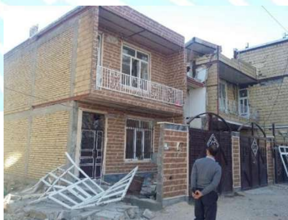
شکل ۱۴-۱۳- نمونه‌ای از ساختمان دوطبقه کلافدار سرپل ذهاب که خسارت اندکی متحمل شده است
