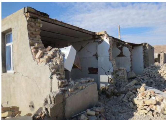
شکل ۷-۶- تخریب دهانه پاتاق سقف طاق ضربی
