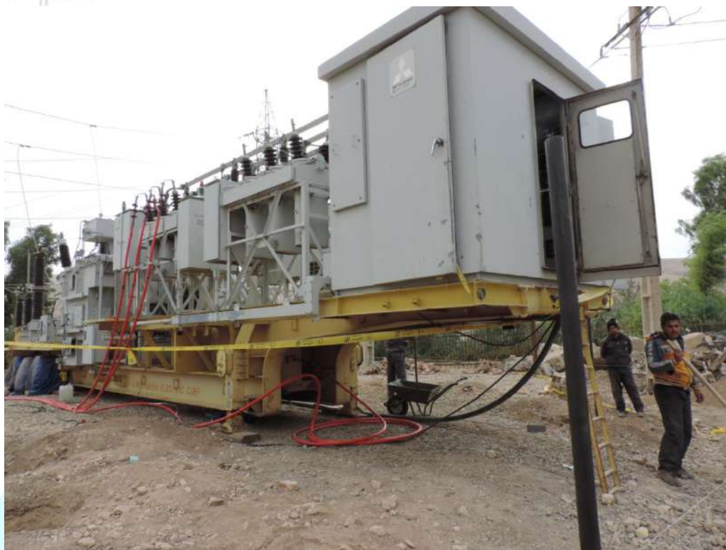
شکل ۱۰-۲۷- پست سیار ۶۳kV که بعد از زلزله برای کمک به پست آسیب دیده مستقر گردید.
