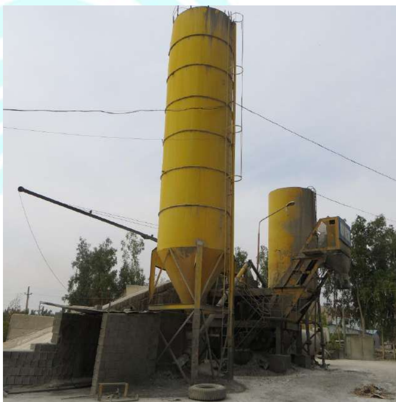
شکل ۱۱-۱۳- آسیب جزئی وارده به سازه سیلوی سیمان کارخانه بتن آماده محرابی - شهرک صنعتی سرپل ذهاب
