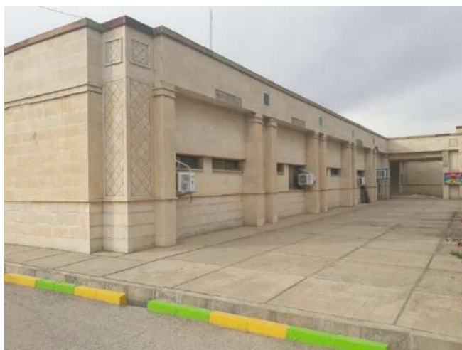
شکل ۱۲-۵۰- ریزش نمای سنگی بیمارستان در اثر زلزله
