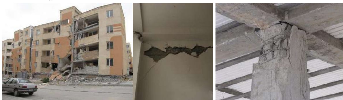
شکل ۵-۶- نمایی از شکست‌های برشی در ستون و دیوار برشی به علت ضعف بتن (طبقه ضعیف)
