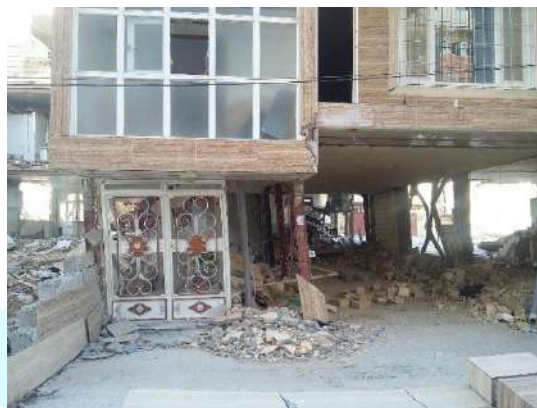
شکل ۱۴-۱۴- بروز طبقه نرم در پیلوت ساختمان، سرپل ذهاب
