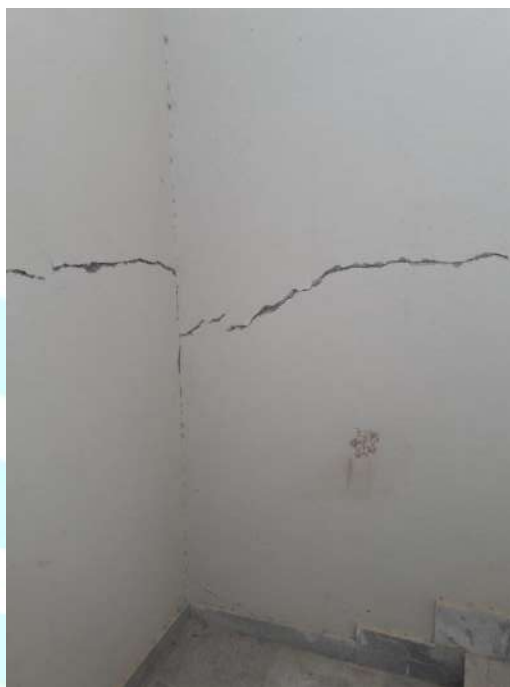
شکل ۱۲-۶۴- ترک‌خوردگی دیوار راه پله
