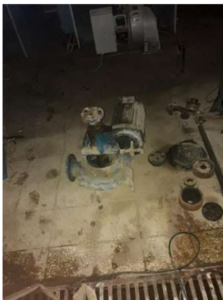
شکل ۱۲-۵۹- خارج شدن پمپ‌ها از مدار
