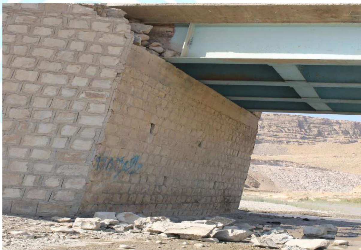
شکل ۱۰-۶- فروریختن بخش بالایی کوله پل فلزی با دو دهانه ناشی از عدم یکپارچگی کوله
