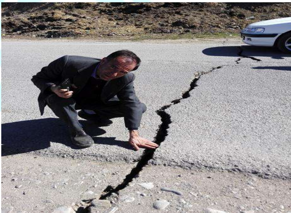
شکل ۱۰-۱۲- آسیب دیدن بدنه راه بر اثر میدان کششی زمین در محور تازآباد-سرپل ذهاب
