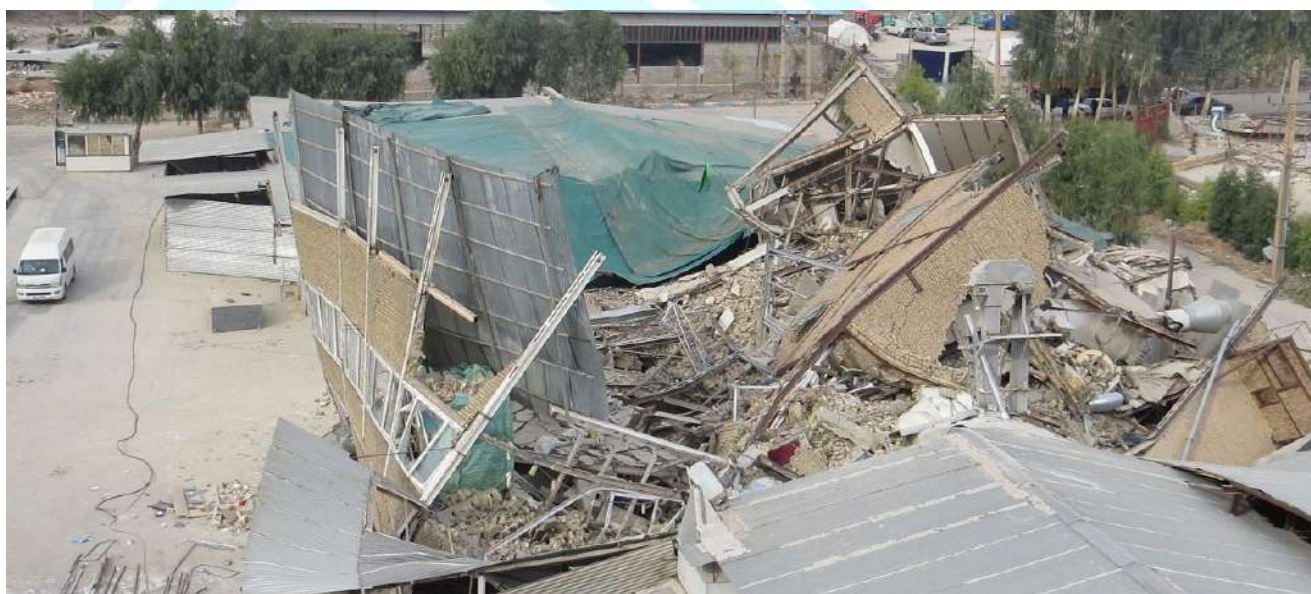
شکل ۱۱-۶- تخریب صد در صد سالن آسیاب گندم کارخانه آرد قصر شیرین در شهرک صنعتی سرپل‌ذهاب
