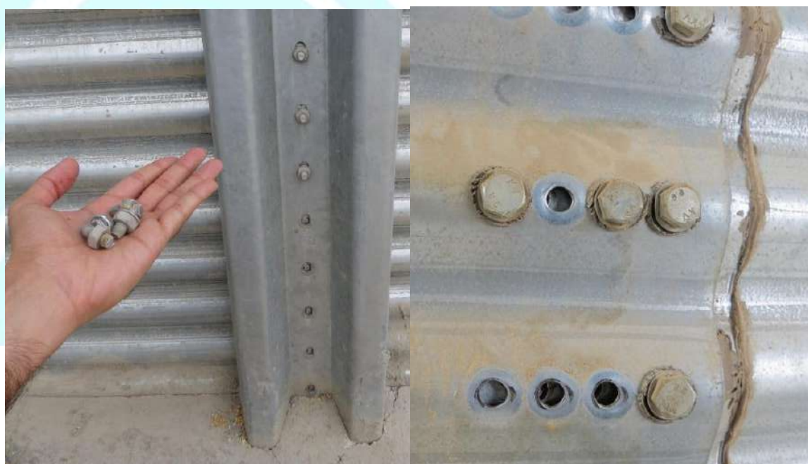
شکل ۱۱-۴- بریده شدن پیچ‌های سولجرهای سیلوه‌ها در تراز دیواره فونداسیون
