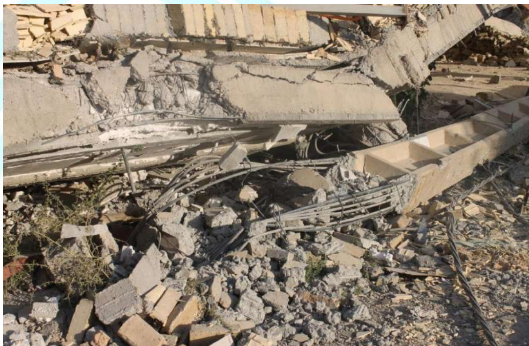
شکل ۱۰-۳۲- شکست تیر و پارگی کابل برق ناشی از فروریزش ساختمان بتن آرمه مجاور
