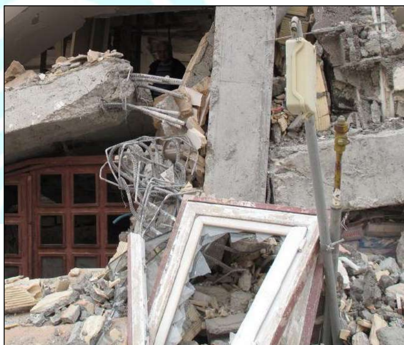
شکل ۸-۵۵- شکست چشمه اتصال و همچنین عدم مهار مناسب آرماتورهای دال پله در چشمه اتصال
