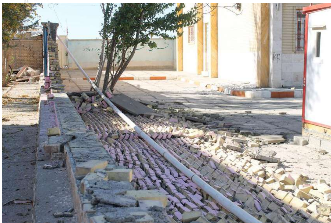
شکل ۱۰-۴۵- آسیب دیدن لوله گاز بر اثر فروریزش دیوار تکیه‌گاه لوله
