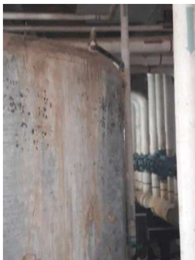
شکل ۱۲-۵۶- ترکیدن مخزن آب
