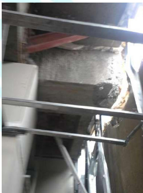
شکل ۱۲-۴۱- وقوع ضربه بین دو ساختمان در محل تیرهای کنسول بتنی
