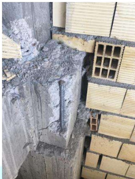
شکل ۵-۱۸- عدم اجرای خم ۹۰ درجه (گونیا) یا مهار مناسب در انتهای میلگردهای طولی ستون که در تراز بالا به ادامه آن نیاز نیست.
