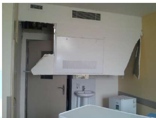
شکل ۱۲-۳۸- جدایی سقف کاذب از محل نصب در محل در ورودی و انسداد مسیر فرار
