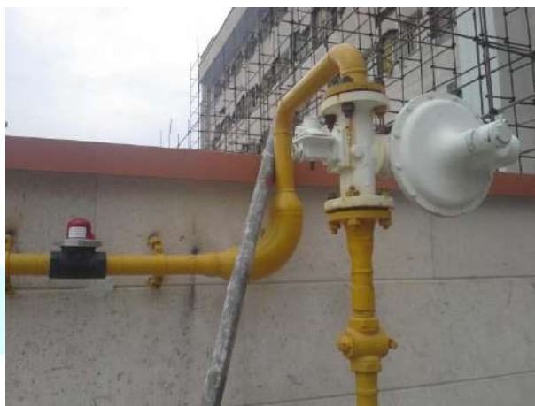
شکل ۱۲-۴۰- رگولاتور تعویض شده پس از آسیب و شیر قطع گازی که عمل نکرد
