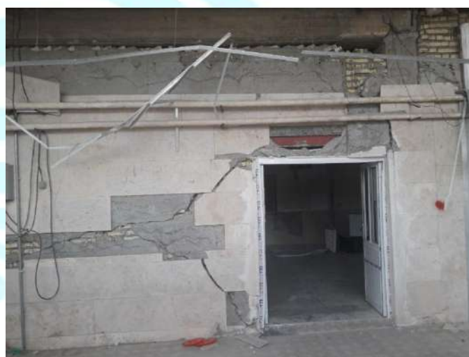
شکل ۱۲-۱۳- ترک خوردگی دیوارها
