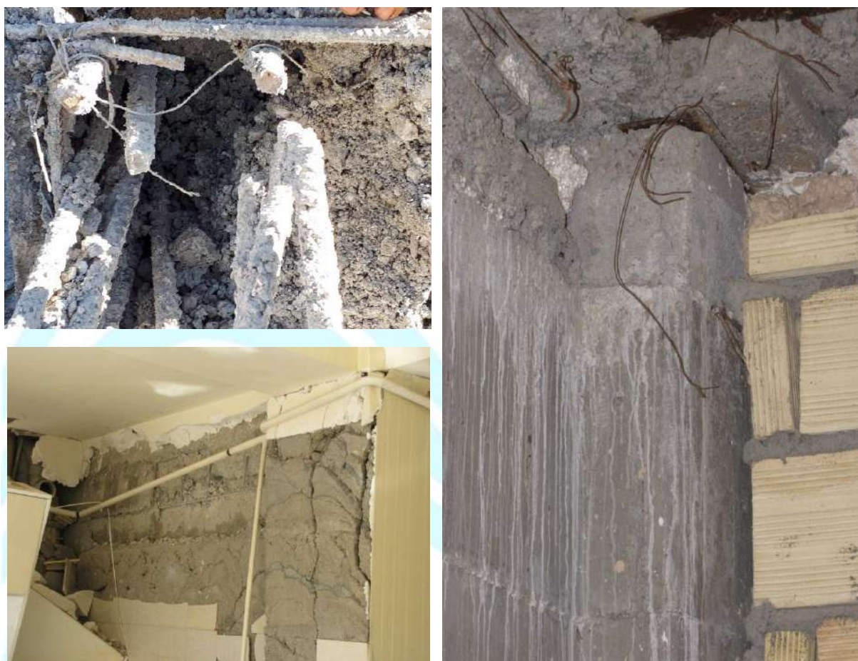
شکل (۵-۱۵) - عدم رعایت ضوابط ساخت بتن، بتن‌ریزی و تراکم بتن (تخلخل و ضعف پایایی و مقاومت)
