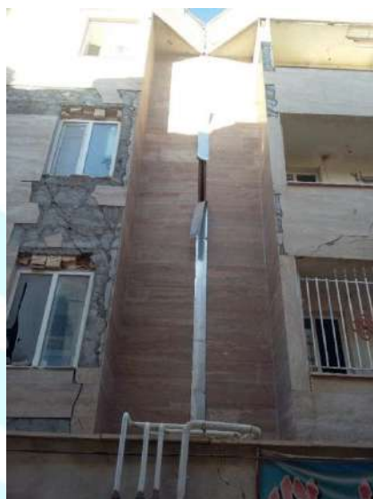
شکل ۱۴-۱۲- خسارت وارد به دیوار و نمای ساختمان و همچنین اثر ضربه ساختمان‌های مجاور به یکدیگر در شهرک شهید شیروودی سرپل ذهاب
