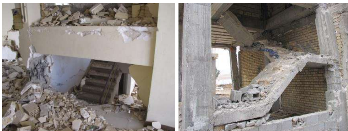
شکل ۵-۴- ایجاد ستون کوتاه در تیرهای میان طبقه پله و آسیب دیدگی ستون‌های متصل به آن
