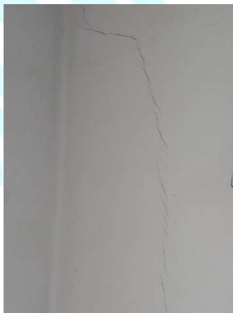
شکل ۱۲-۸۲- ترک‌خوردگی در دیوارهای اتاق‌های طبقه اول
