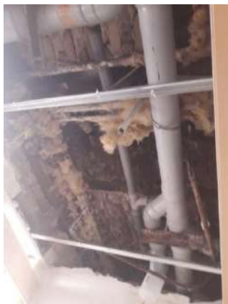
شکل ۱۲-۸۳- شکست لوله فاضلاب در اثر سقوط اجسام داخل سقف کاذب روی لوله در اتاق آزمایشگاه بیمارستان
