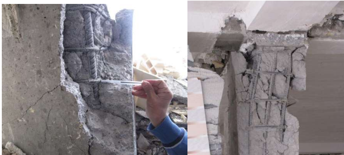
شکل ۵-۱۲- ضخامت زیاد پوشش بتن
