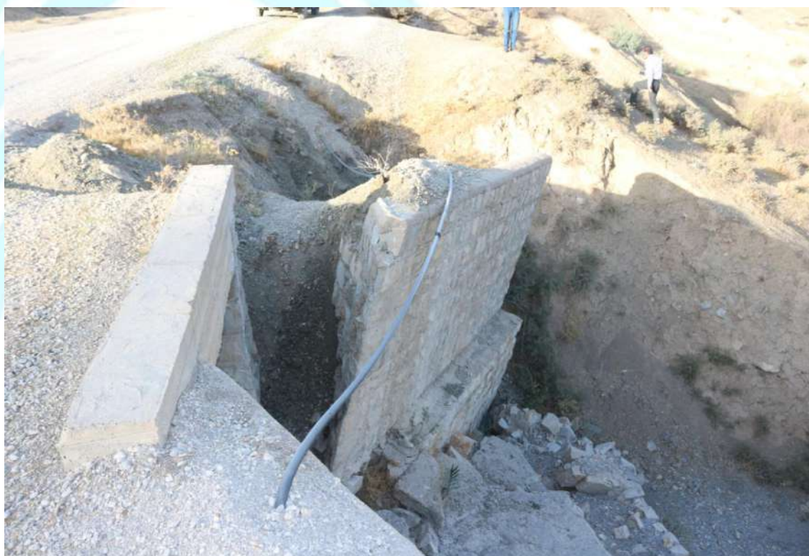
شکل ۱۰-۱۰- فرو ریختن کوله پل با دهانه ۴ متری در مسیر روستاهای کانی خنجر و نیمه کاره
