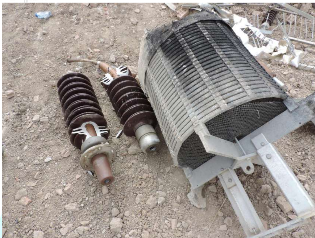
شکل ۱۰-۲۱- سقوط پوشینگ و موج‌گیر پست برق ۶۳kV سرپل ذهاب
