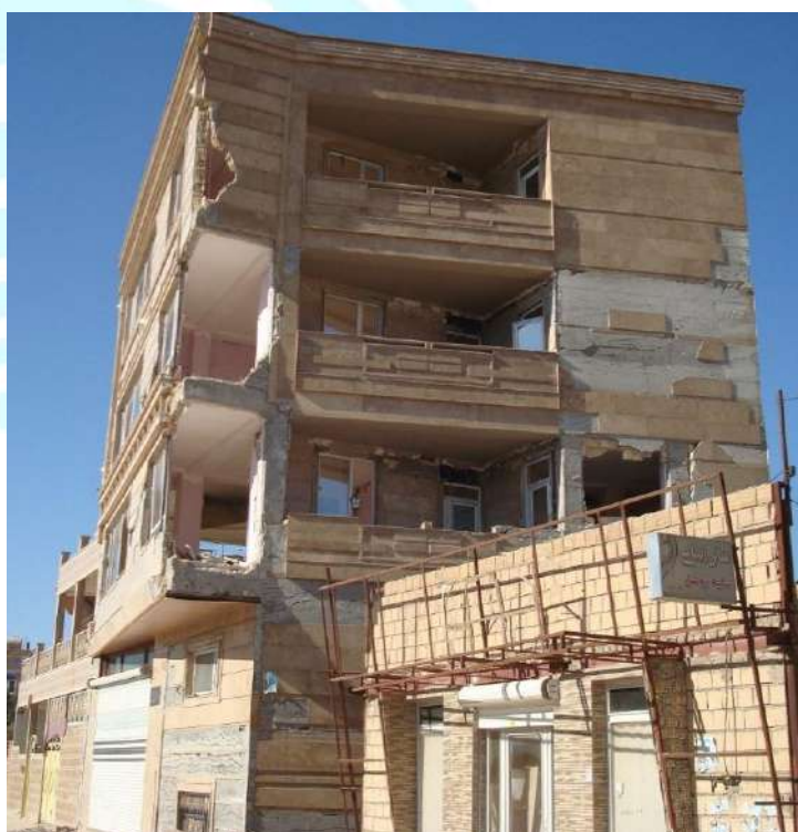
شکل ۱۴-۶- خرابی خرپشته، دیوار و نمای ساختمان‌ها
