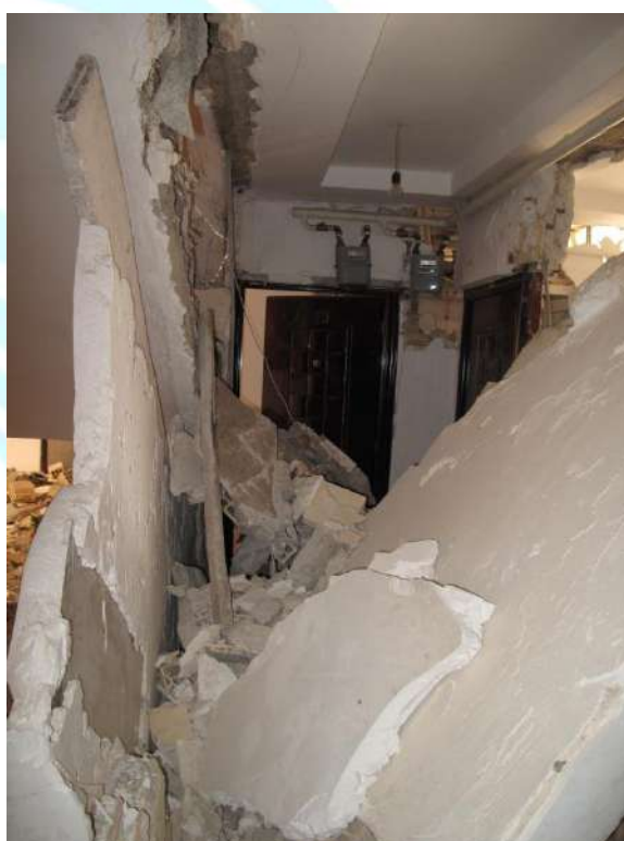
شکل ۸-۱۷- ریزش جداکننده‌ها و وجود الوار چوبی در آن
