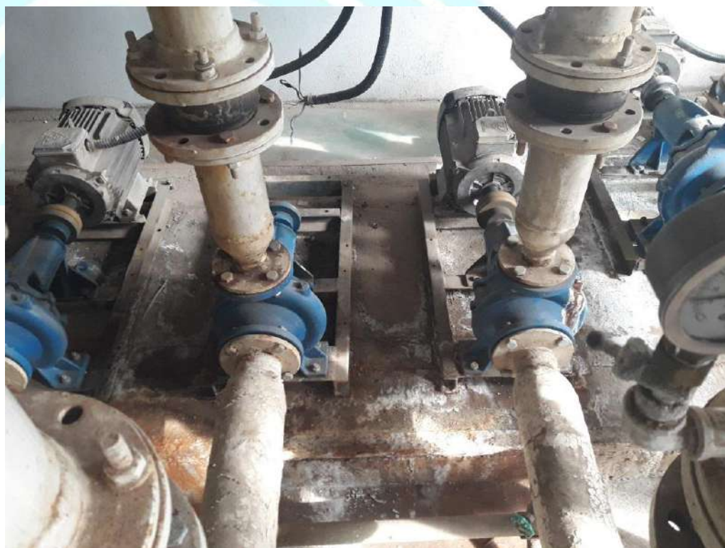
شکل ۱۲-۶۹- آسیب به پمپ در اثر زلزله
