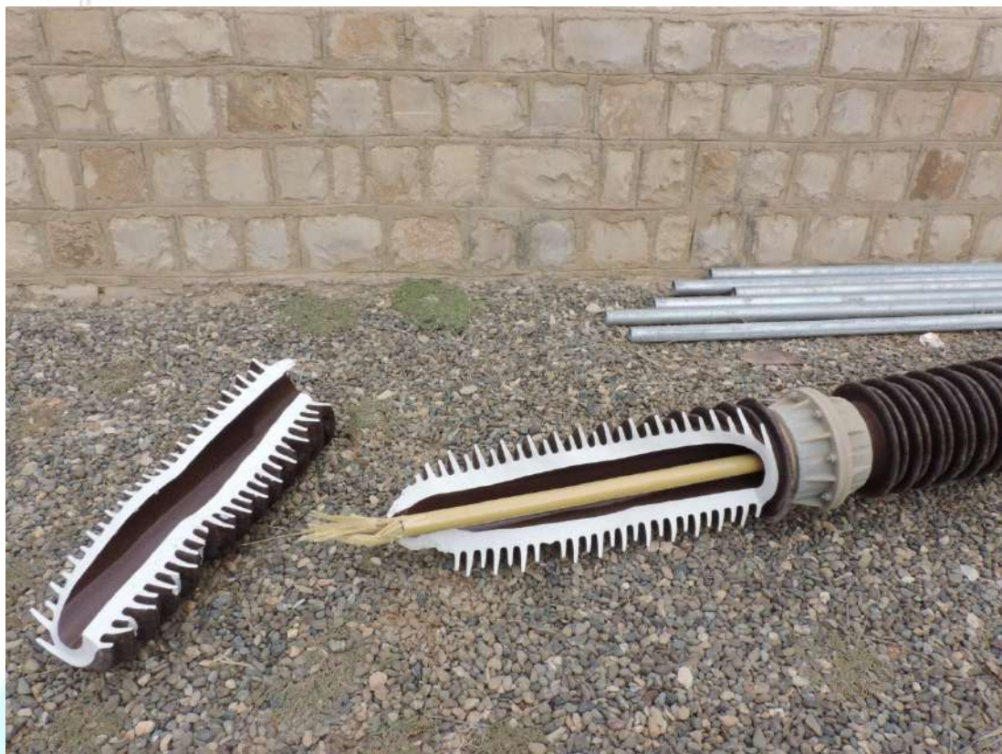
شکل ۱۰-۲۹- سقوط و شکستن تجهیزات پست ۲۳۰kV سرپل ذهاب
