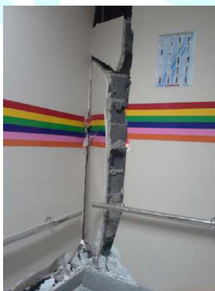
شکل ۱۲-۳۹- آسیب شدید ناشی از جابجایی قابل توجه به دیوارهای پانل گچی با لایه میانی از بلوک سیمانی سبک
