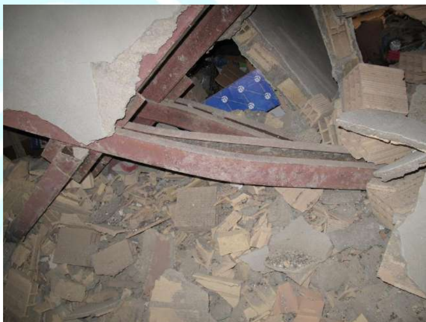
شکل ۸-۲۴- کمانش مهاربند دوبل ناودانی به دلیل عدم استفاده از لقمه و عملکرد مجزای هر ناودانی
