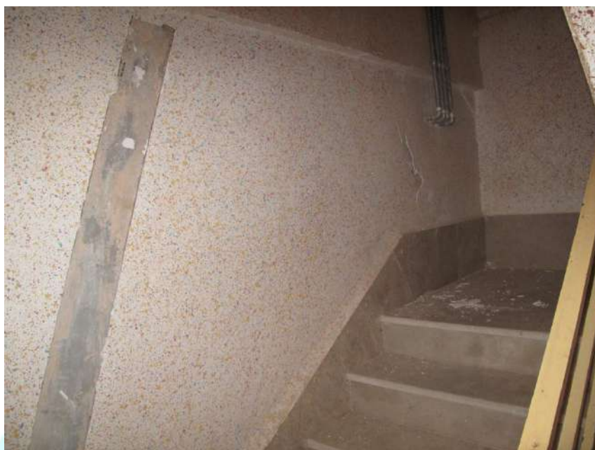
شکل ۸-۳۷- عمکرد مهار بند که باعث ریزش بخش نازک‌کاری شده است
