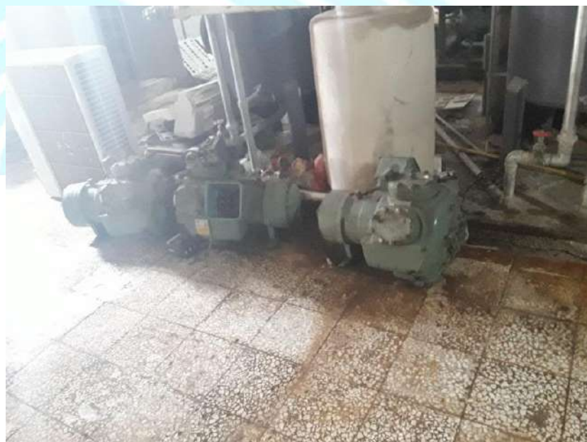
شکل ۱۲- ۵۵- آسیب در پمپ‌های آب
