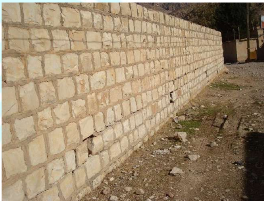
شکل ۱۳-۸- دیوار حائل سنگی بین فضای دو مدرسه که در زلزله دچار آسیب شده بود.
