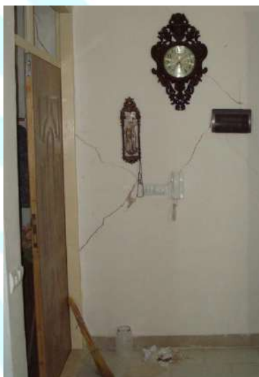
شکل ۱۴-۱۰- ترک‌های ایجاد شده در یکی از دیوارهای داخلی ساختمان مسکن مهر فرهنگیان
