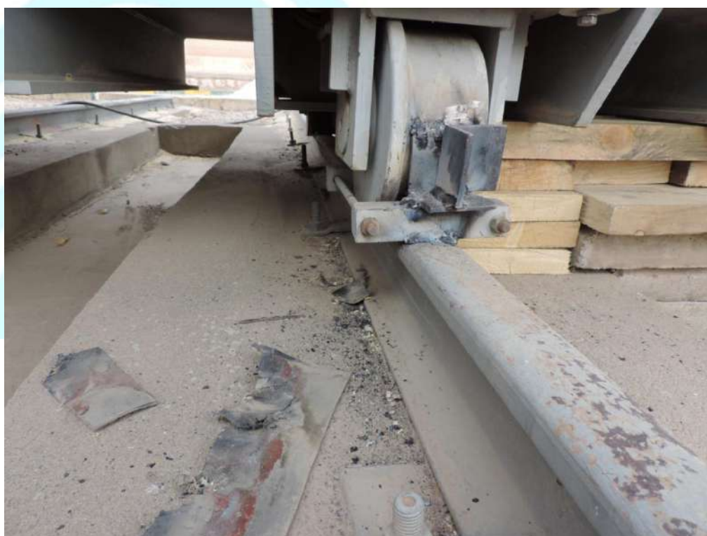
شکل ۱۰-۲۰- تثبیت موقت ترانس که از روی ریل در پست ۶۳kV سرپل ذهاب افتاد
