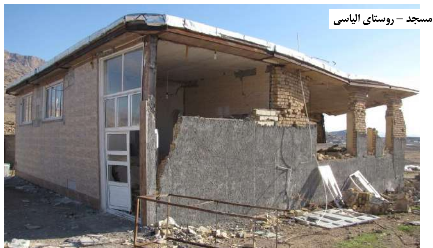
شکل ۷-۱۴- آسیب شدید یک ساختمان مصالح بنایی کلاف دار آجری به علت توسعه غیراصولی در پلان (بدون کلاف و اشکوب)
