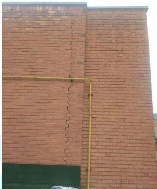
شکل ۱۲-۷۴- تخریب بخشی از نمای بیمارستان
