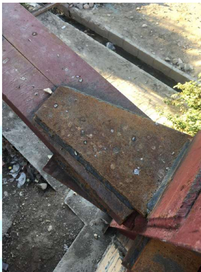
شکل ۸-۳۹- تیپ اتصالات خمشی رایج در منطقه که نقطه ضعف آن شکست جوش اتصال ورق به بال ستون است
