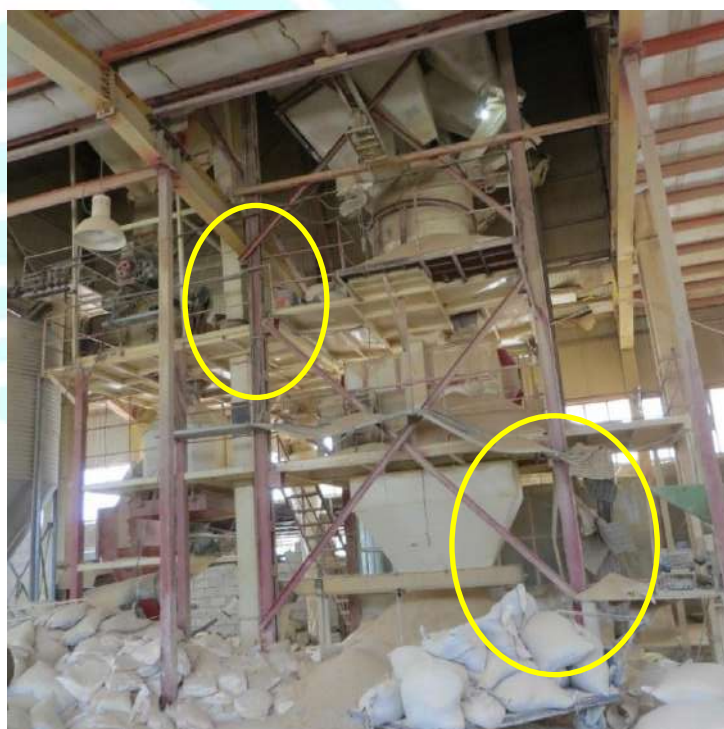
شکل ۱۱-۱۶- کنده شدن قیف و تجهیزات تولید خوراک در ارتفاع
