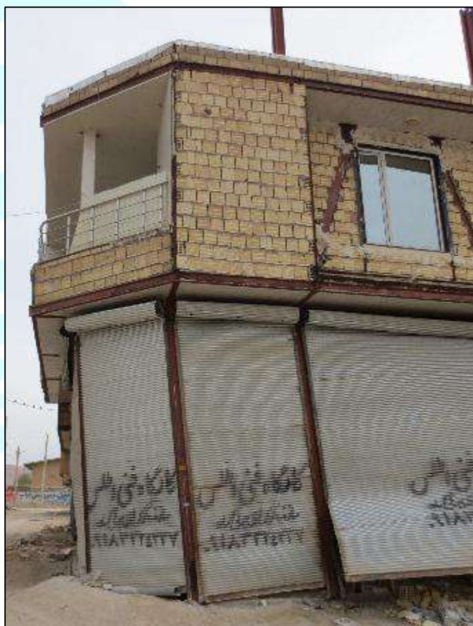
شکل ۶-۱۶- مود خرابی پیچشی و طبقه نرم
