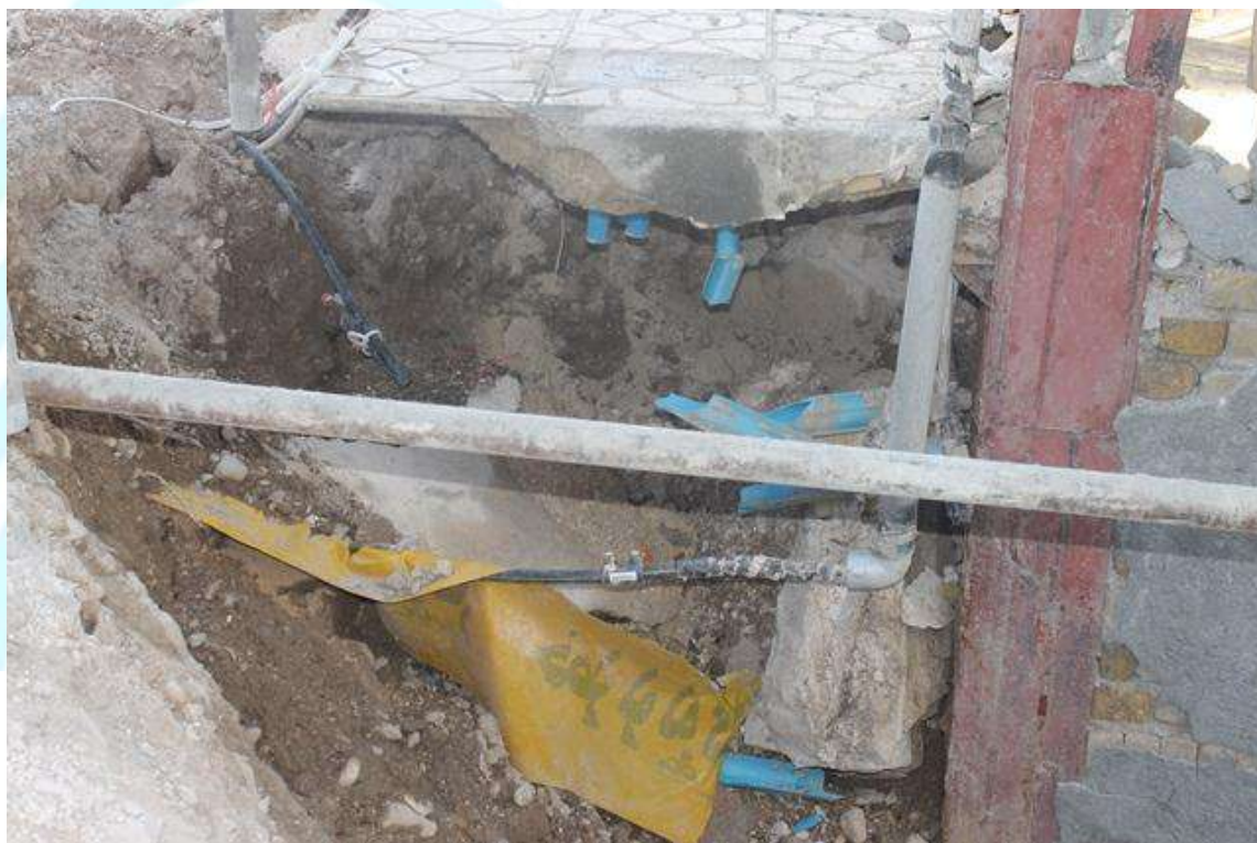
شکل ۱۰-۴۴- شکست لوله‌ها و انشعابات خانگی در اثر نشست خاک و دریافت زیاد سازه
