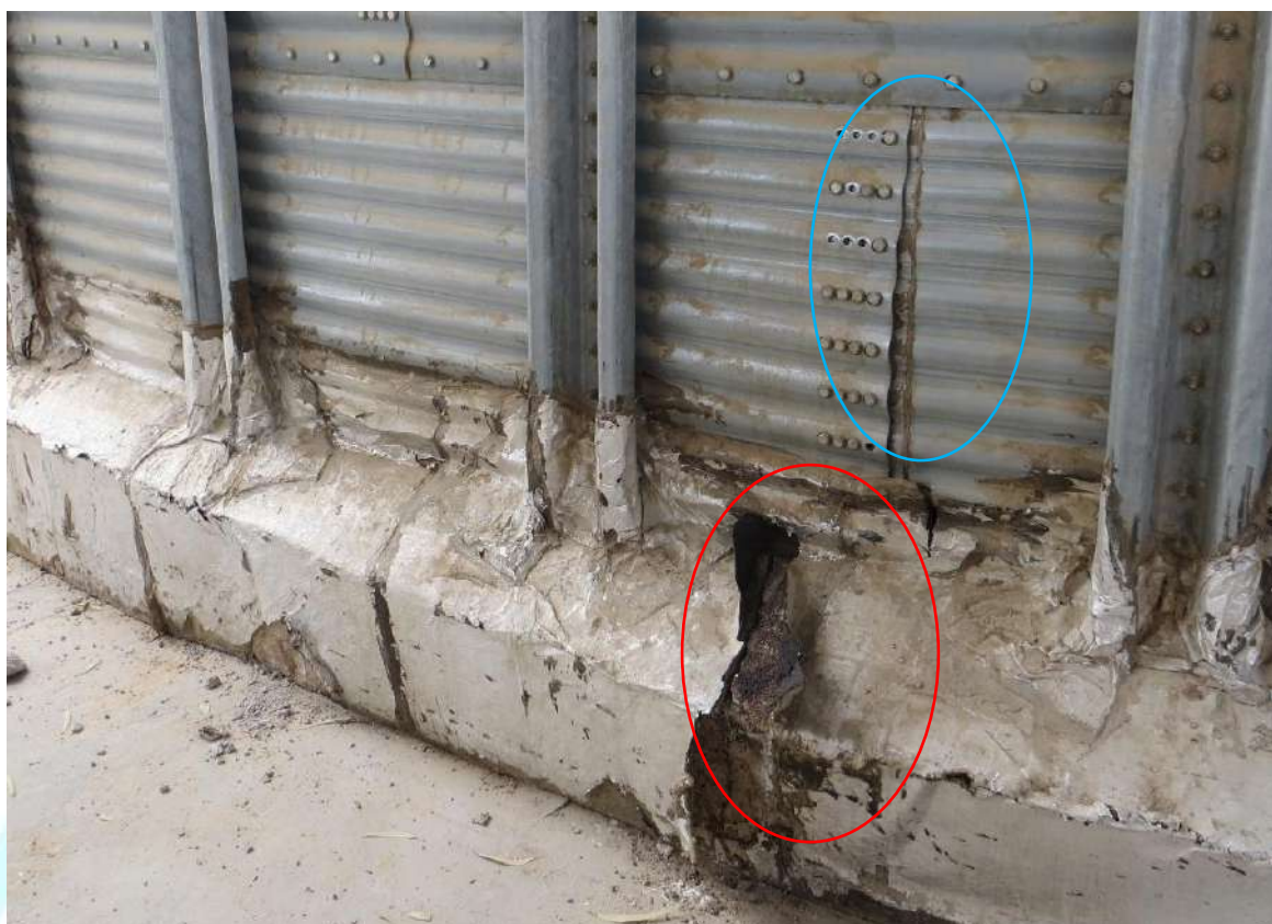
شکل ۱۱-۵- بریده شدن پیچ‌های ۸.۸ اتصال ورق‌های موج‌دار و ایجاد شکست در دیواره فونداسیون سیلو
