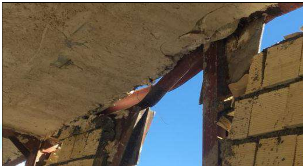
شکل ۶-۱۷- کمانش پیچشی تیر پیوند به دلیل عدم تعبیه مهار جانبی تیر
