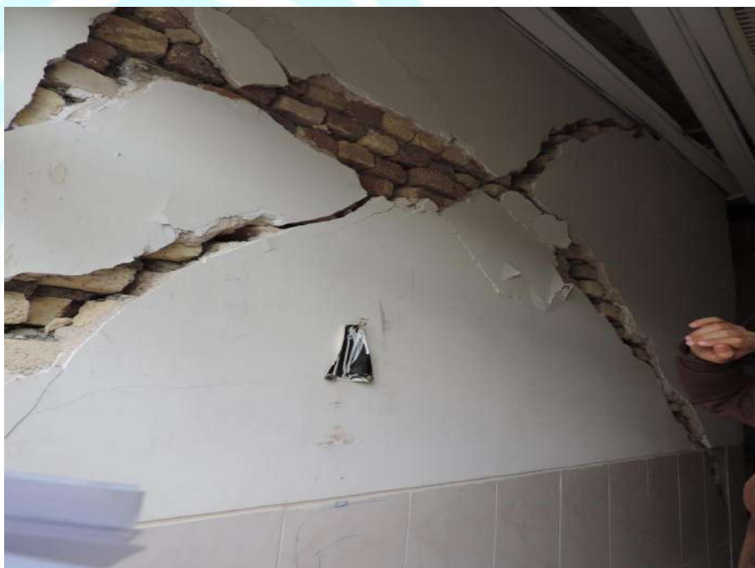
شکل ۱۰-۲۴- آسیب دیدن اتاق کنترل در پست ۶۳kV سرپل ذهاب
