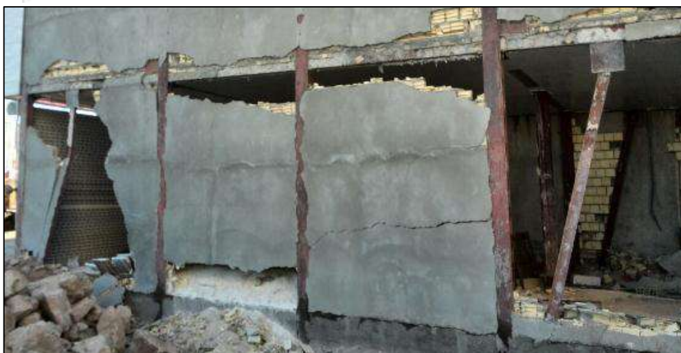
شکل ۶-۱۳- استفاده غیرضروری و نادرست از مهاربند واگرا در دهانه‌های کناری سازه
