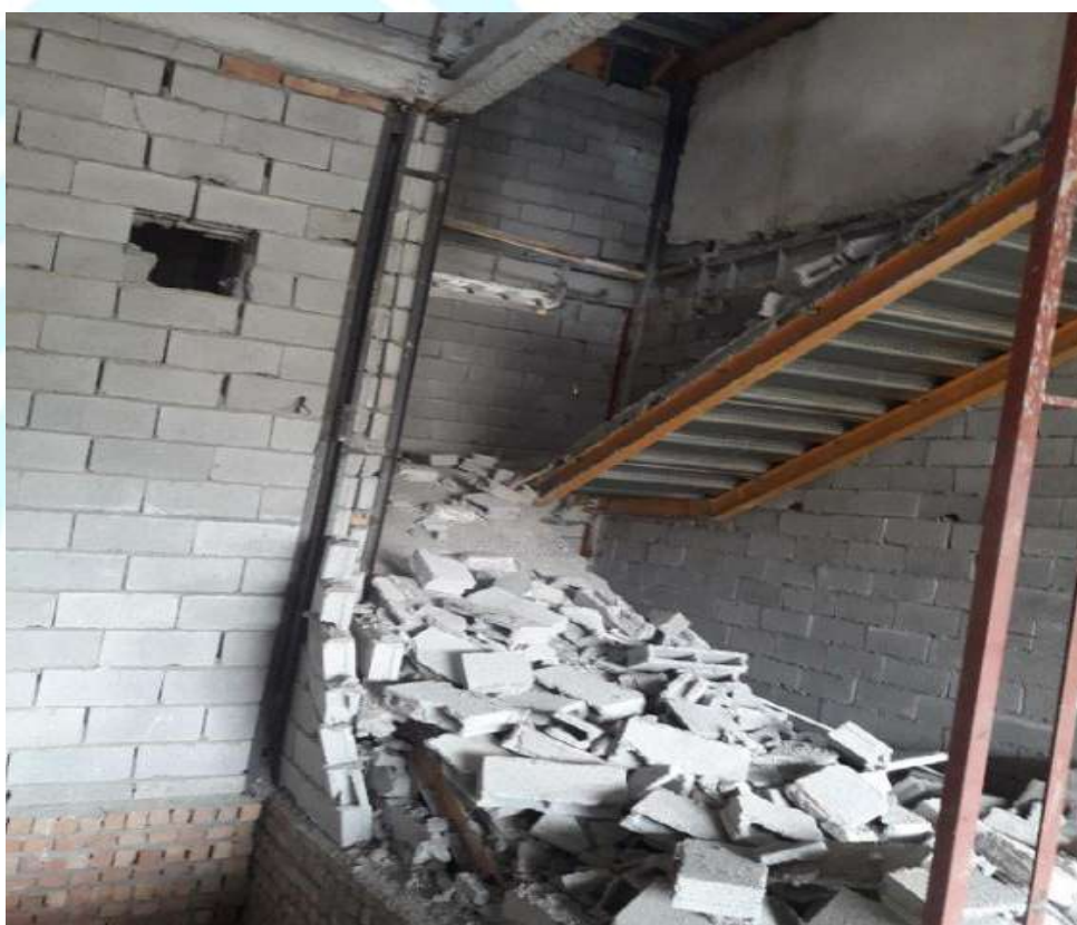
شکل ۱۲-۲۲- تخریب دیوارهای جداکننده
