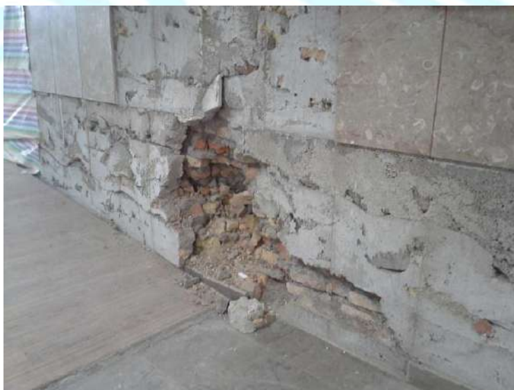
شکل ۱۲-۳۰- آسیب قابل توجه به دیوار ساختمان فولادی در طبقه‌ی دوم و مجاورت بخش زنان در محل ضربه‌ی تیر
