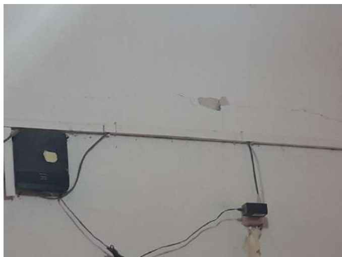
شکل ۱۲-۸۸- ترک خوردگی دیوارها
