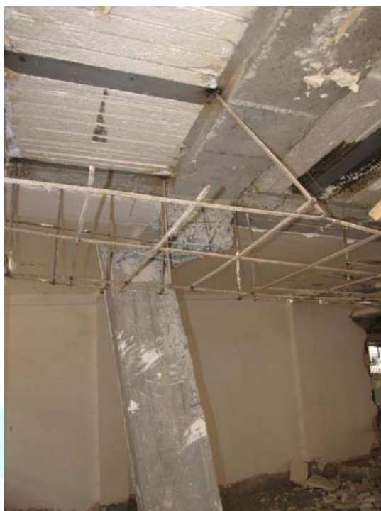
شکل ۸-۵۴- شکست برشی ستون
