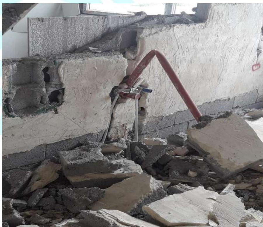
شکل ۱۲-۲۴- تخریب لوله‌کشی آب
