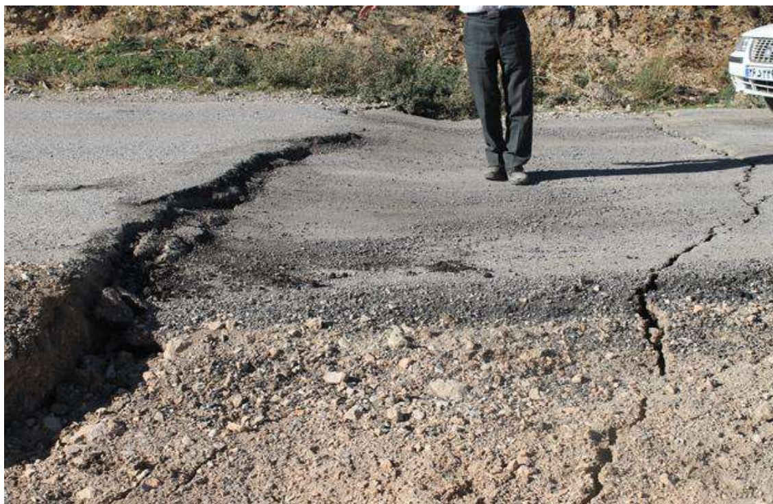
شکل ۱۰-۱۳- آسیب دیدن بدنه راه بر اثر رانش زمین ناشی از میدان کششی در محور تازه‌آباد-سرپل‌ذهاب
