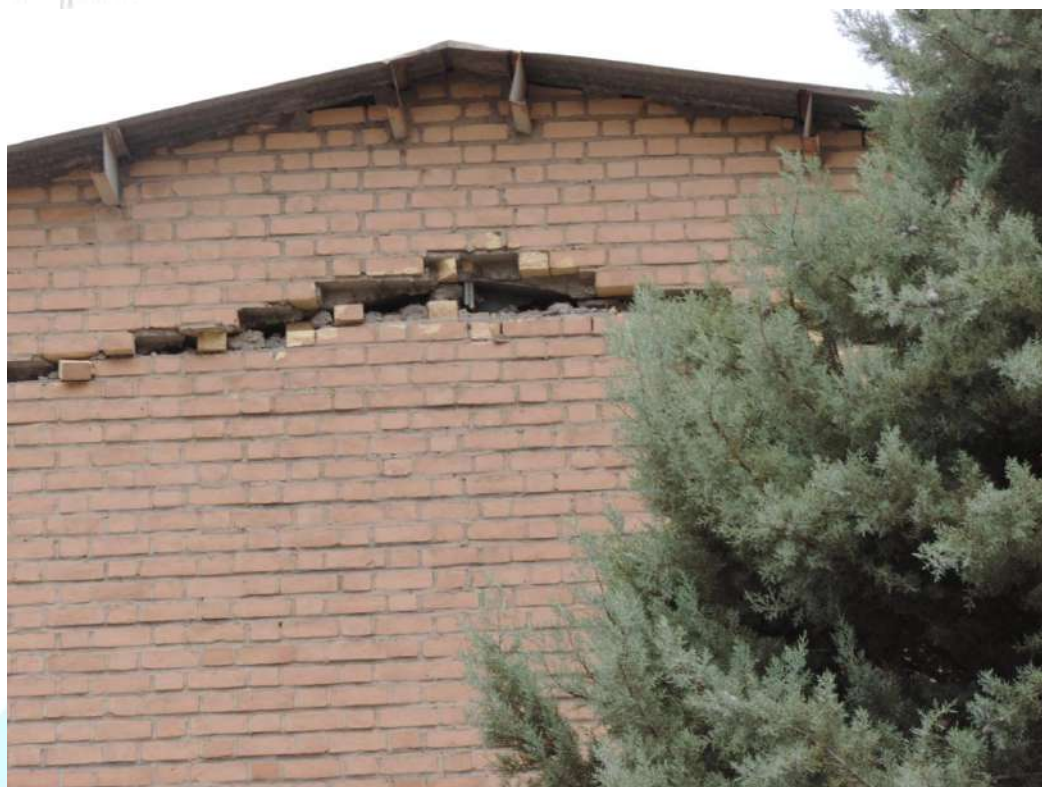
شکل ۱۰-۴۰- شکسته شدن و جدا شدن دیوار سوله تصفیه‌خانه سرپل‌ذهاب
