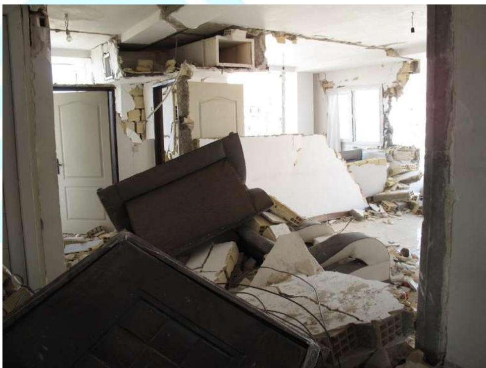
شکل ۸-۱۵- فرو ریزش یکپارچه دیوار جداکننده
