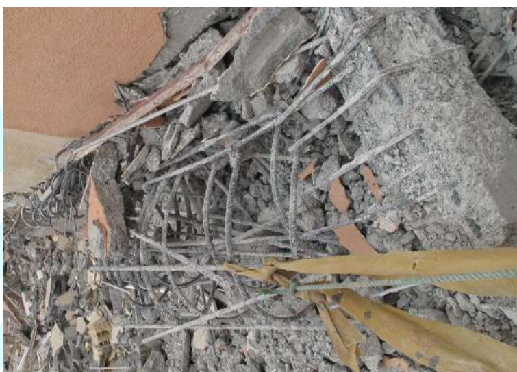
شکل ۸-۵۲- عدم مهار جانبی آرماتورهای قائم دیوار
