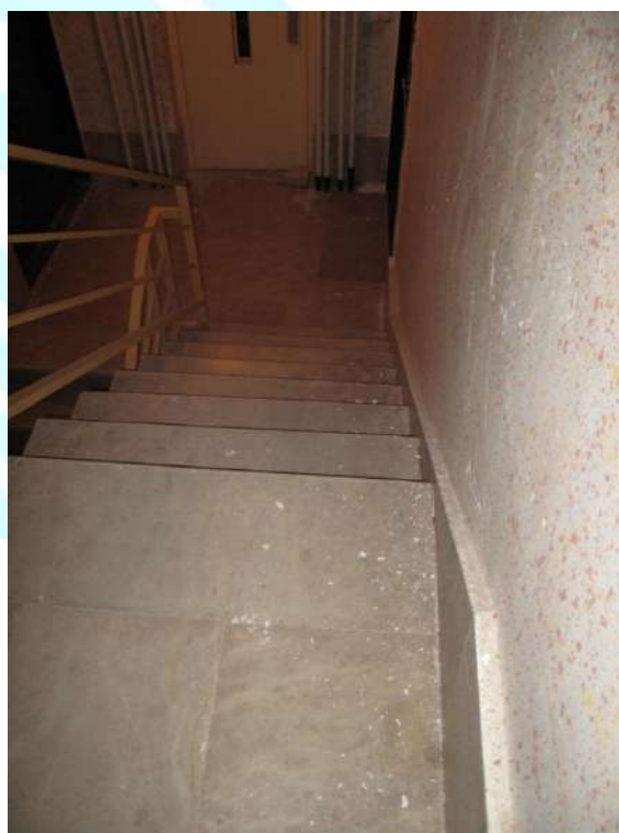
شکل ۸-۴۱- عدم خسارت در راه پله‌ها
