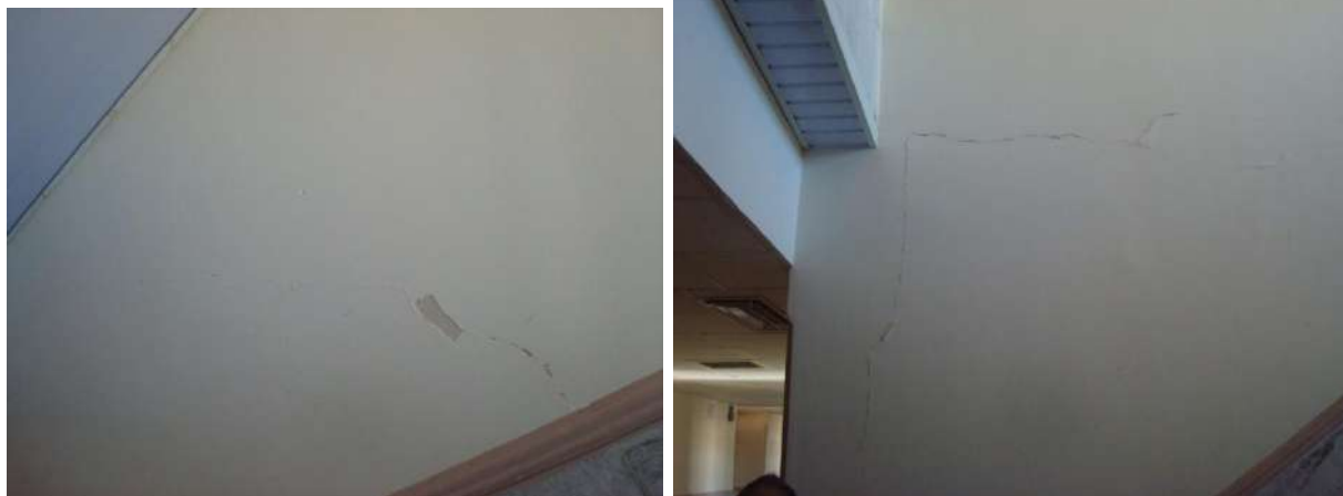
شکل ۱۳-۳- ترک‌های اندک ایجاد شده در دیوارهای داخلی مدرسه حمزه بیگی
