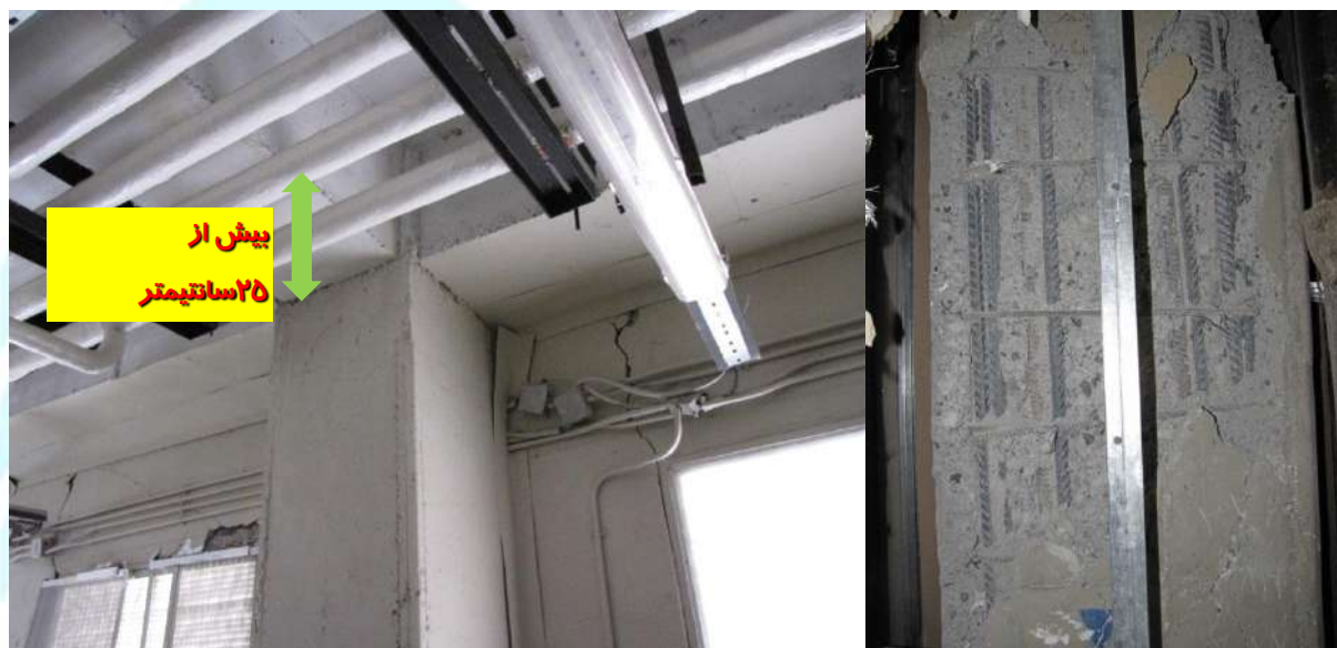
شکل ۵-۸- نمایی از اتصال تیر به ستون (ستون ضعیف - تیر قوی) و فواصل زیاد خاموت گذاری در بیمارستان اسلام‌آباد غرب
