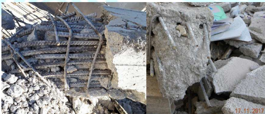
شکل ۵-۲۰- عملکرد ضعیف وصله‌های پوششی که ضعف بتن عامل اصلی جدایش محسوب می‌شود.
