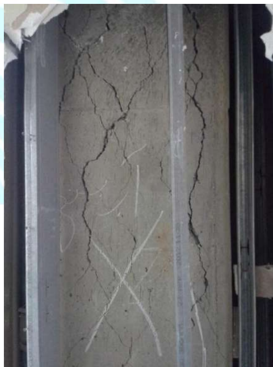
شکل ۱۲-۳۵- ترک‌های طولی و مورب در میانه‌ی ارتفاع ستون در طبقه سوم
