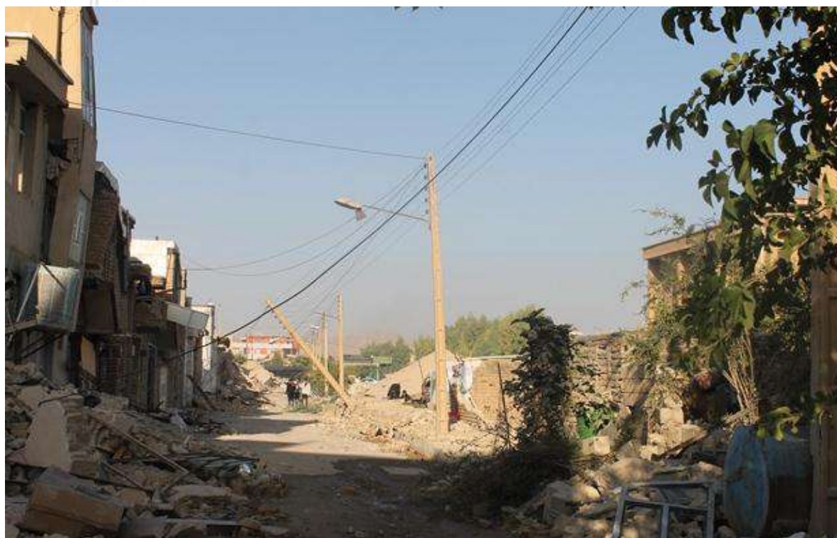
شکل ۱۰-۳۳- شکست و کج شدن تیر برق
