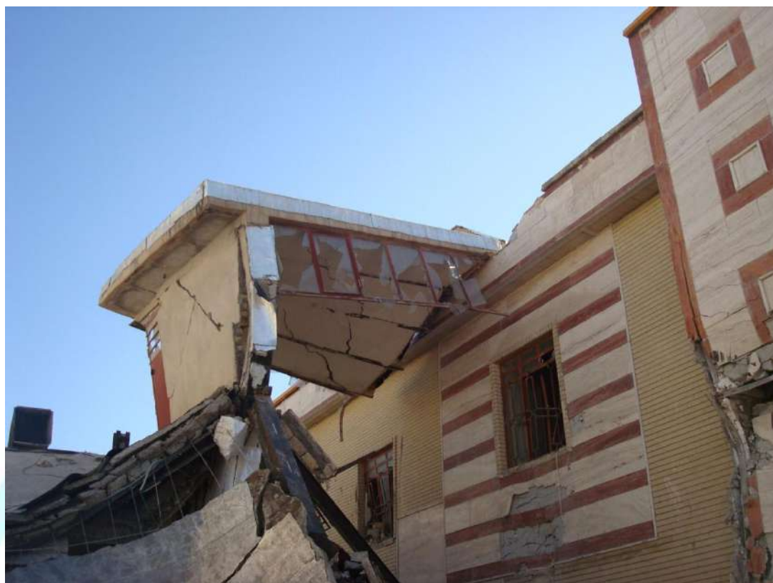
شکل ۱۳-۱۴- آسیب‌های وارد به هنرستان بر اثر فروریزش ساختمان مسکونی مجاور آن
