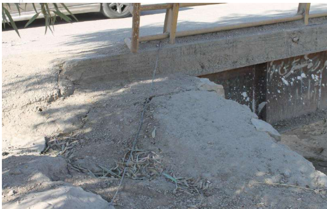
شکل ۱۰-۲- دیوار هادی اطراف کوله‌ها دچار ترک شده (بعد از روستای دارنیله از روستاهای ازگله)
