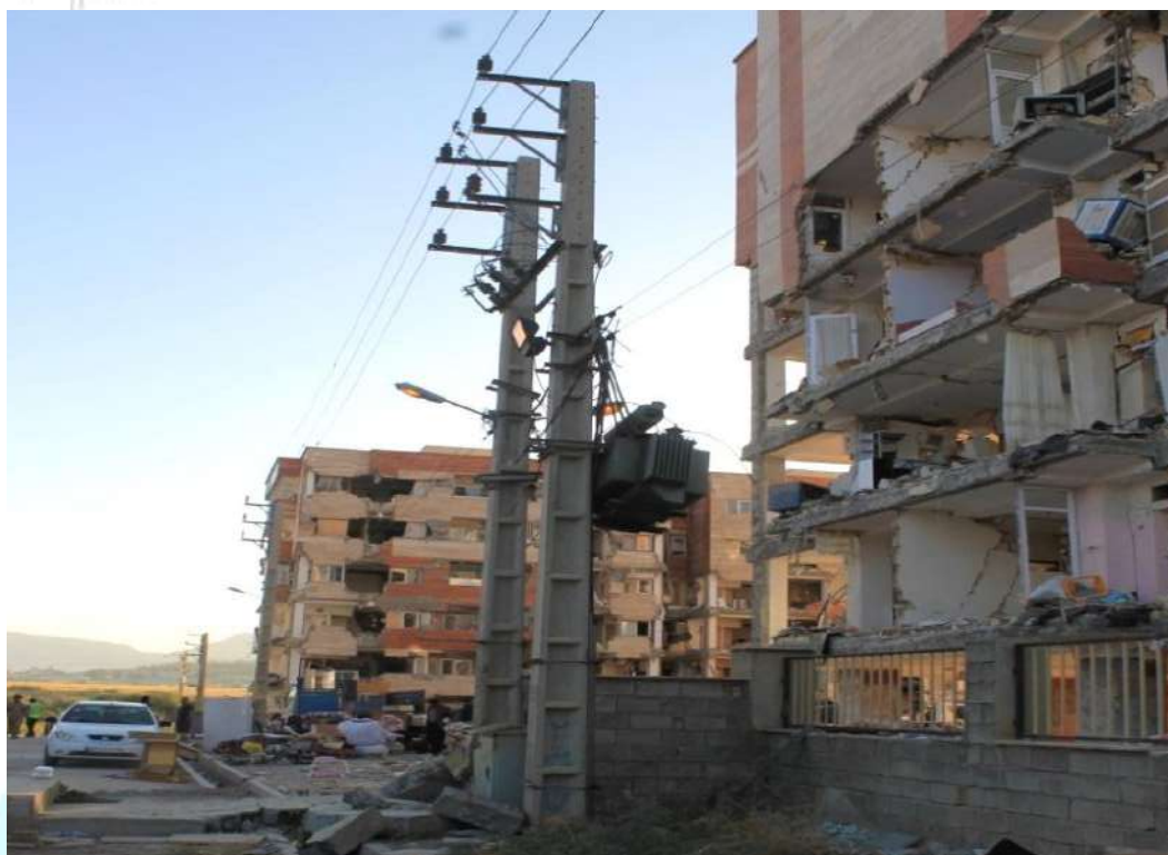
شکل ۱۰-۳۱- آویزان شدن ترانس هوایی برق و قطع برق در محدود مسکن مهر
