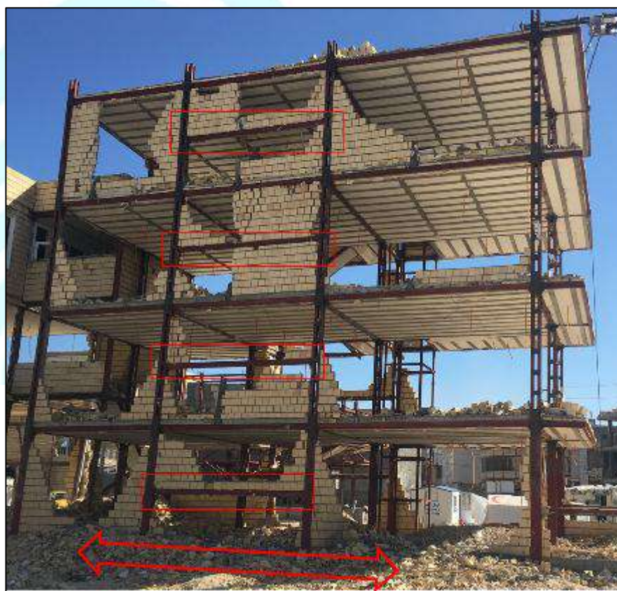
شکل ۶-۲۴- استفاده از تیرهای میان‌طبقه در طبقات به عنوان سیستم باربر لرزه‌ای که باعث عدم وجود سیستم موثر باربر جانبی در جهت مشخص شده در سازه شده است
