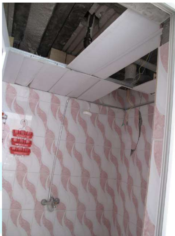
شکل ۸-۱۸- فرو ریزش سقف کاذب
