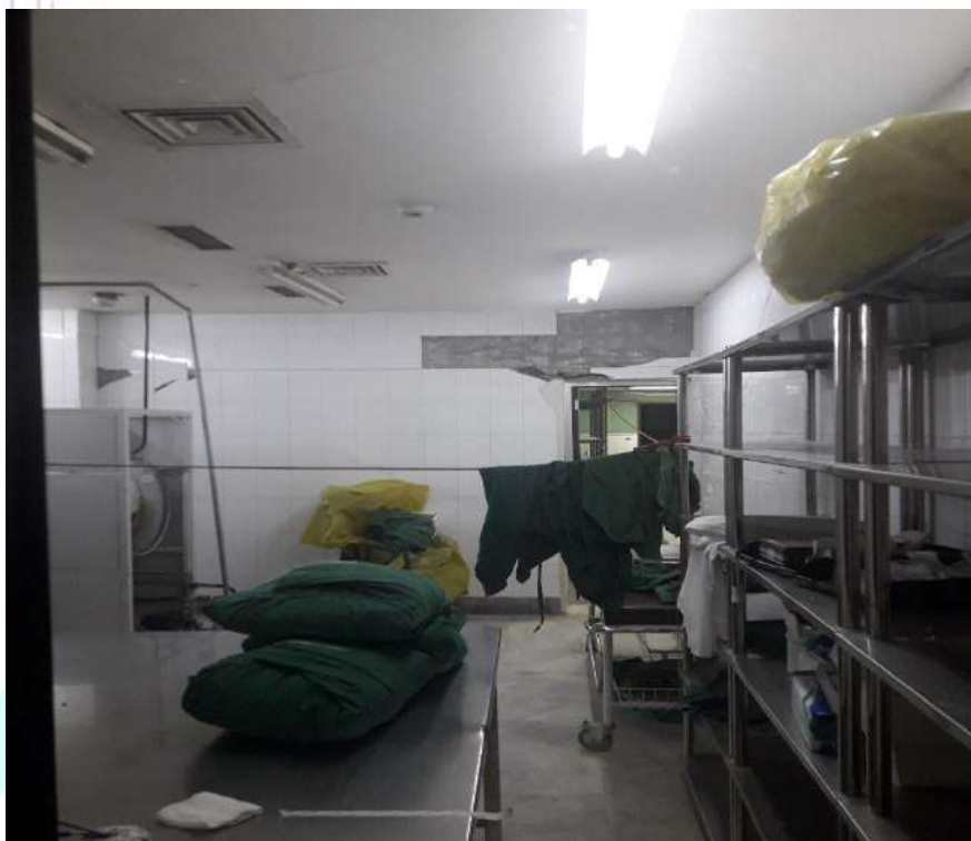
شکل ۱۲-۱۸- تخریب دیوار اتاق عمل
