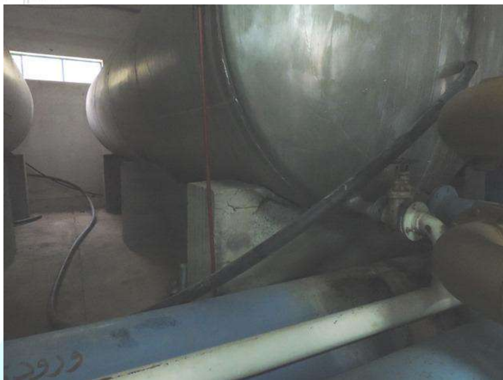
شکل ۱۰-۳۸- آسیب وارده به تکیه‌گاه مخازن تصفیه‌خانه آب سرپل ذهاب
