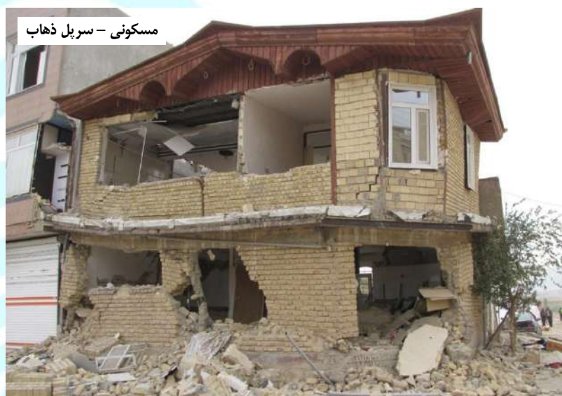
شکل ۷-۱۵- آسیب شدید یک ساختمان مصالح بنایی کلاف دار آجری به علت توسعه غیراصولی بنا در ارتفاع (افزودن طبقه)
