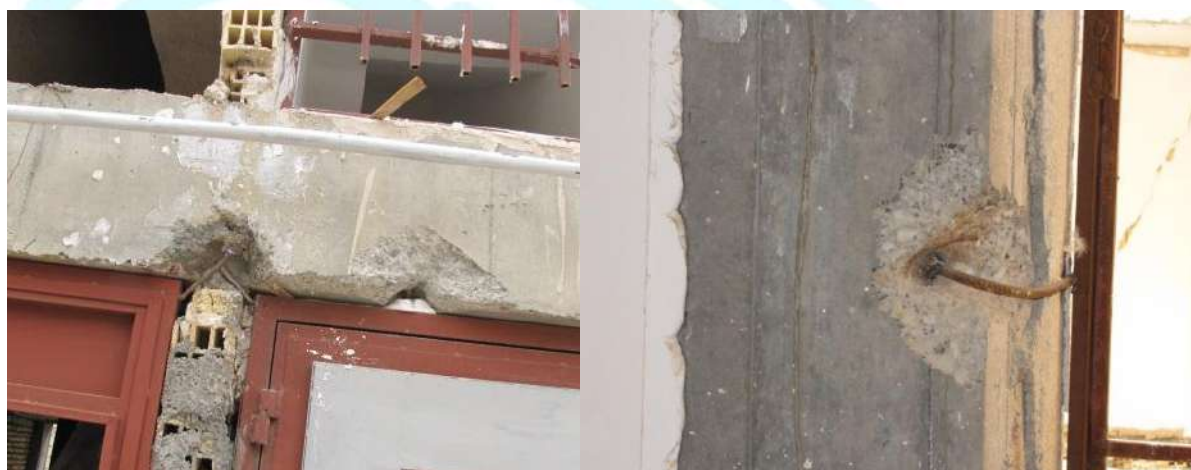
شکل ۵-۲۳- اتصال غیراصولی اجزای غیرسازه‌ای به سازه‌ای
