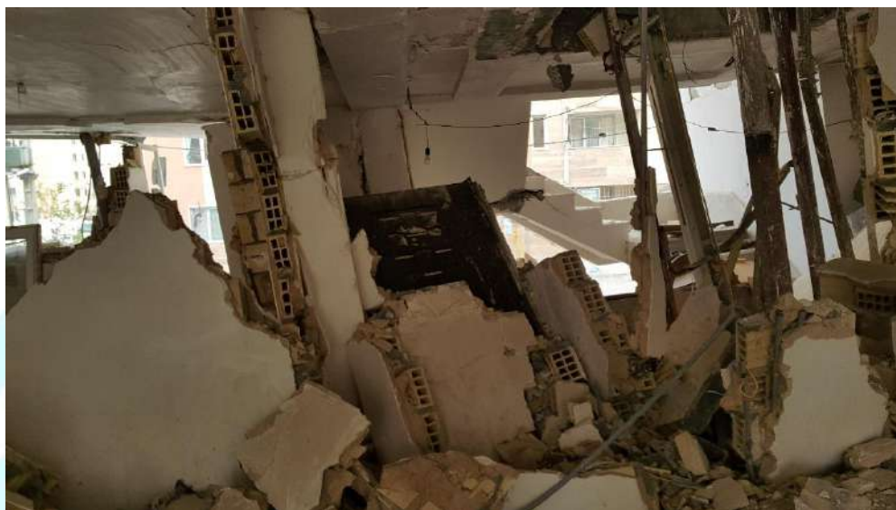
شکل ۸-۵۸- نمونه ای از آسیب‌های غیرسازه‌ای سطح فروریزش
