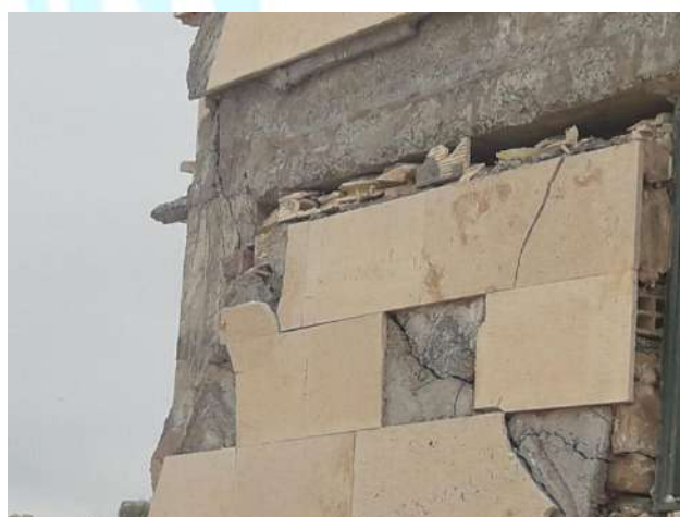
شکل ۱۲-۵۴- خسارت شدید به ساختمان اتاقک هواساز بیمارستان
