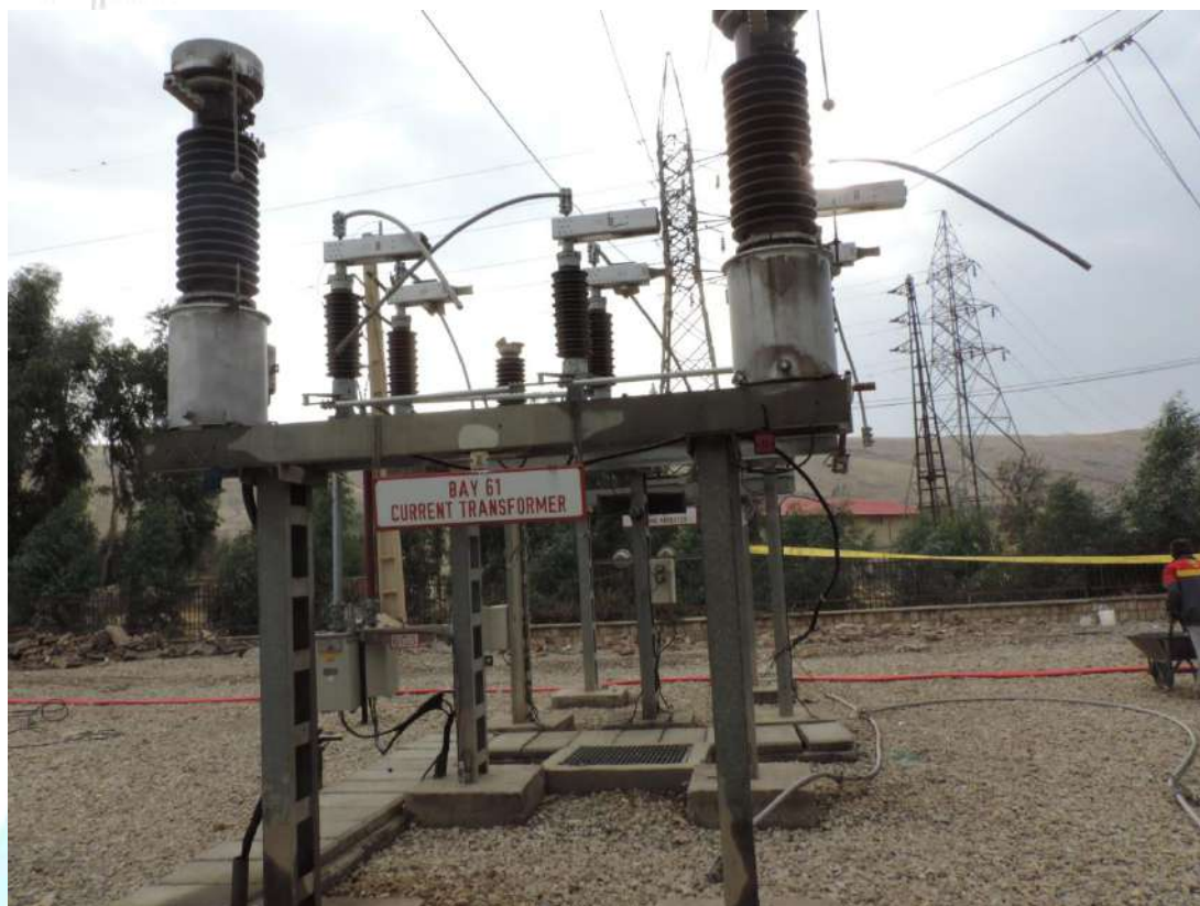
شکل ۱۰-۲۳- آسیب دیدن CT ها در پست ۶۳kV سرپل ذهاب
