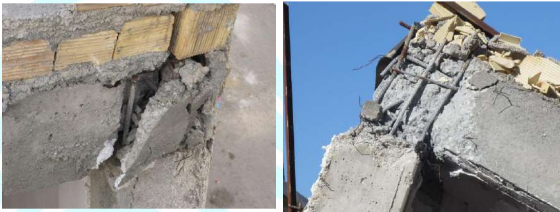
شکل ۵-۱۷- عدم اجرای خم ۹۰ درجه (گونیا) در انتهای میلگردهای طولی ستون
