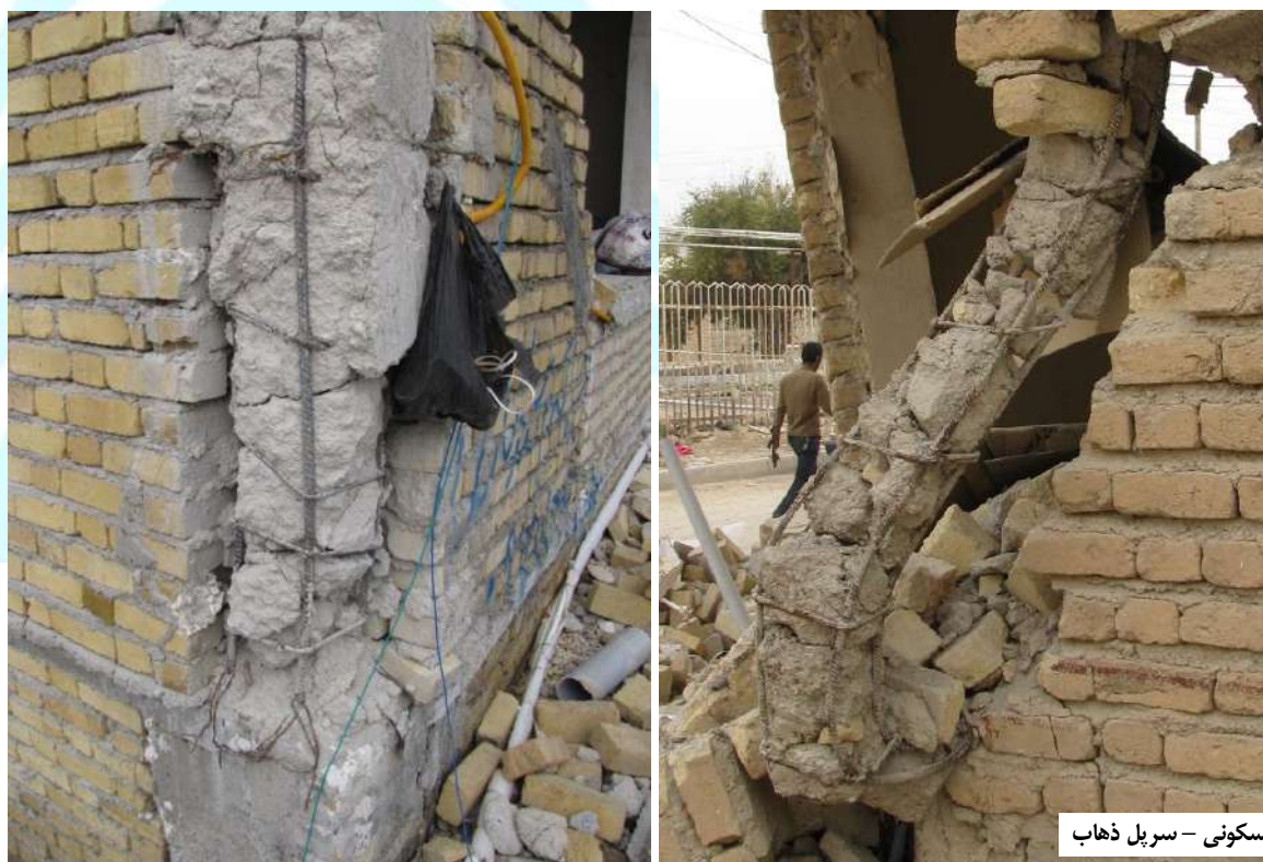
شکل ۷-۱۲- کیفیت نازل بتن کلاف‌ها
