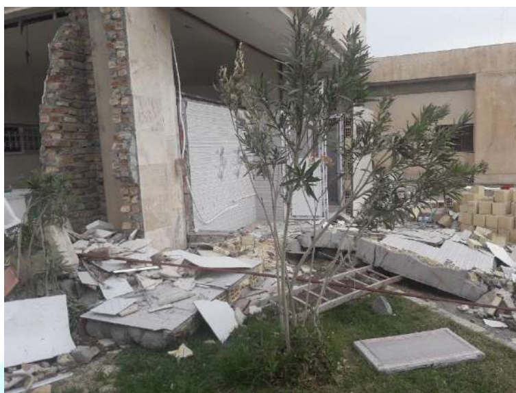
شکل ۱۲-۱۶- ریزش دیوار پیرامونی
