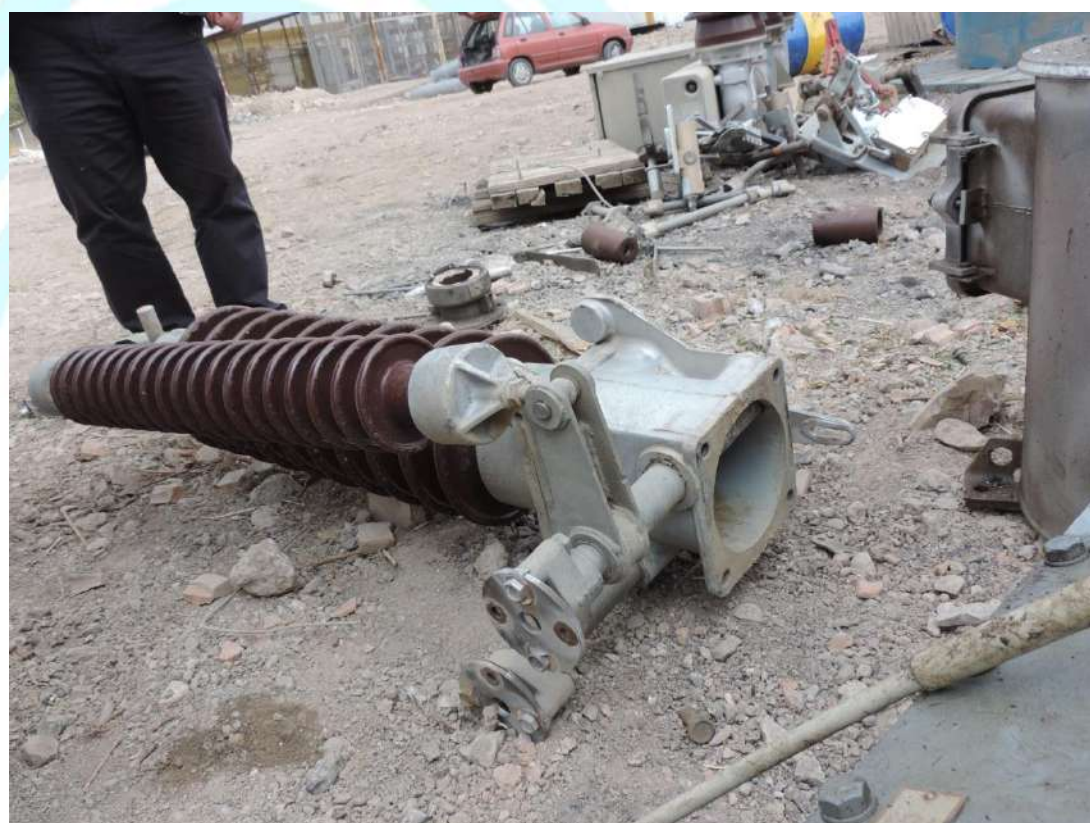
شکل ۱۰-۲۲- سقوط تجهیزات پست ۶۳kV سرپل ذهاب
