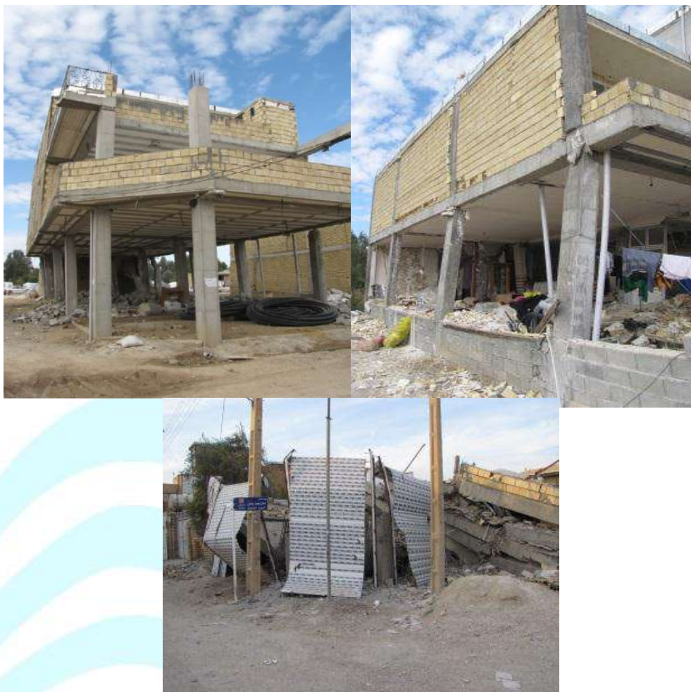
شکل ۵-۱- ایجاد طبقه نرم عمدتاً ناشی از عدم رعایت ستون قوی - تیر ضعیف
