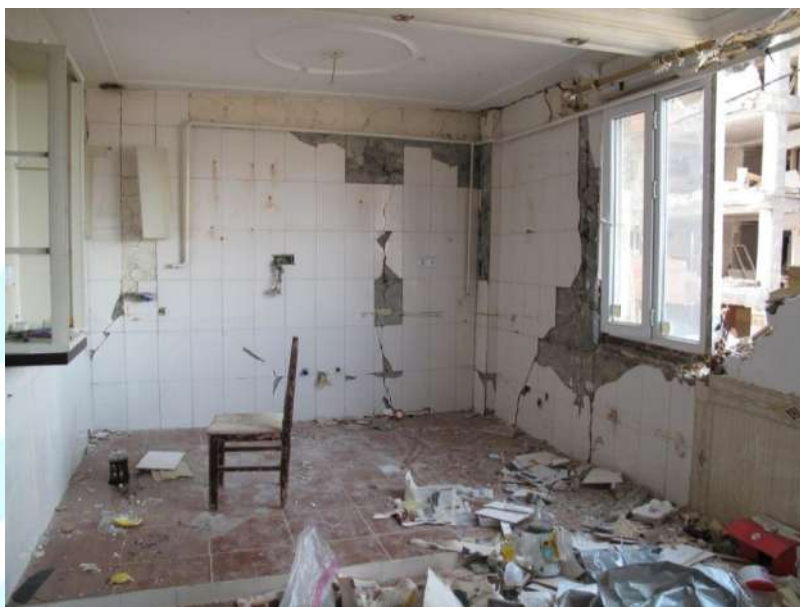
شکل ۸-۳۱- فروریزش دیوار جداگر به خصوص در محل اتصال به پنجره‌ها
