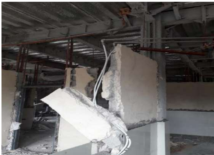
شکل ۱۲-۲۵- تخریب لوله‌کشی آب
