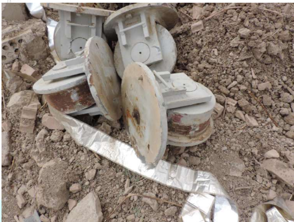
شکل ۱۰-۱۹- چرخ‌های ترانس که از روی ریل در پست ۶۳kV سرپل ذهاب افتاد
