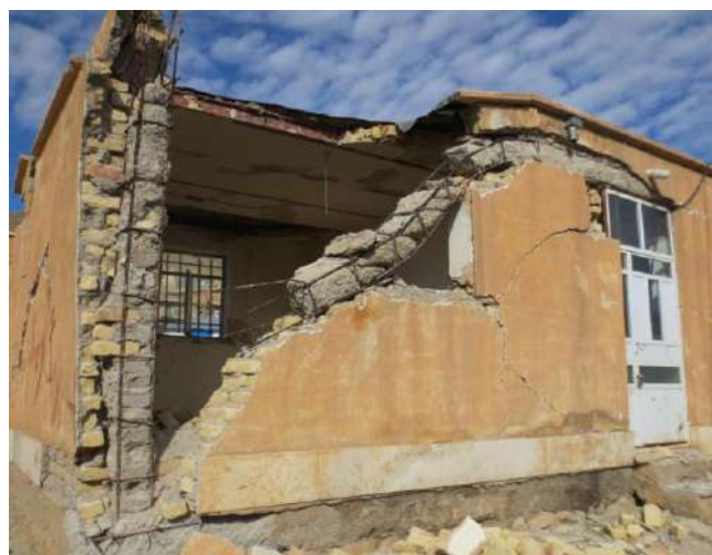
شکل ۷-۲- ترک‌خوردگی و شکست کلاف‌های بتنی
