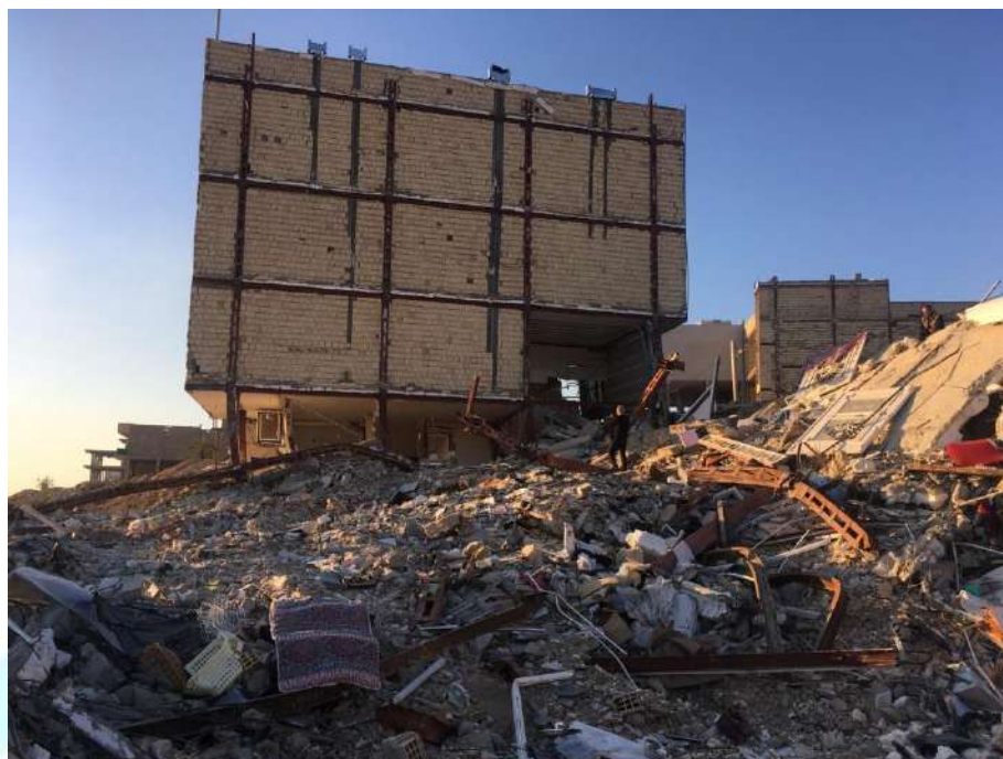
شکل ۹-۱۴- عدم وجود کش در نمای شرقی بدلیل عبور لوله‌های بخاری در ساختمان شاهد
