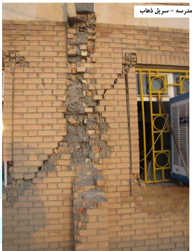
شکل ۷-۱۳- عملکرد ضعیف آجرهای سوراخ‌دار
