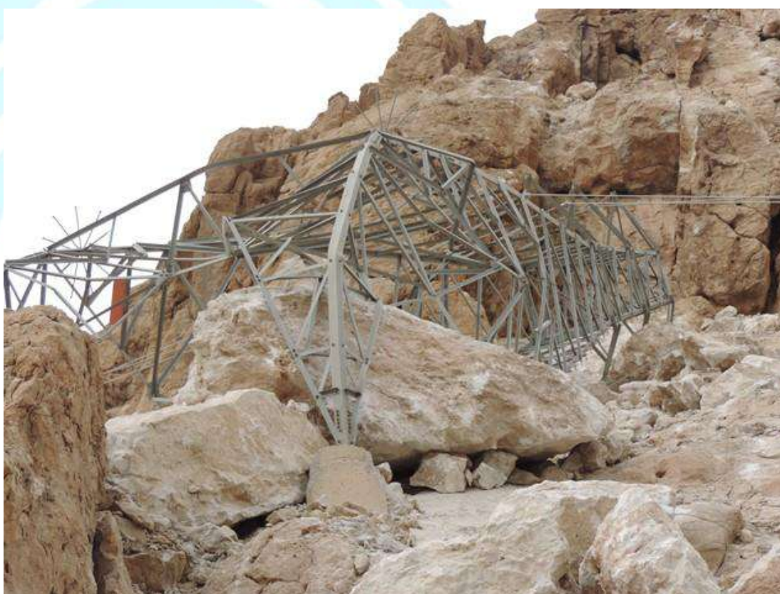
شکل ۱۰-۱۶- سقوط دکل خط انتقال بخش خصوصی بر اثر ریزش کوه
