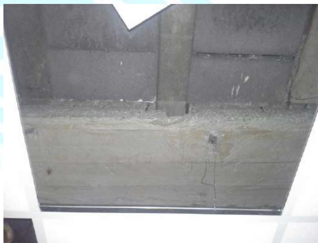
شکل ۱۲-۴۵- کاهش مقطع تیر به دلیل کارگذاری نادرست تیرچه
