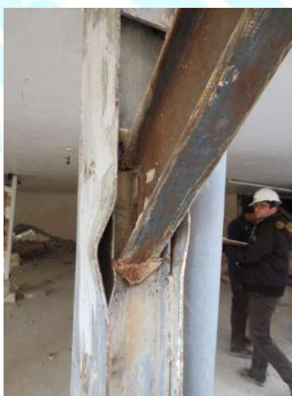
شکل ۸-۳۰- فرو رفتگی دستک نگهدارنده کنسول در اثر مولفه قائم
