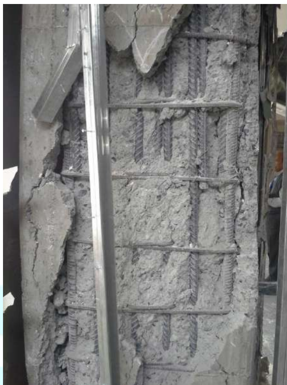
شکل ۱۲-۳۴- آسیب شدید به بتن پوشش و هسته در میانه‌ی ارتفاع ستون
