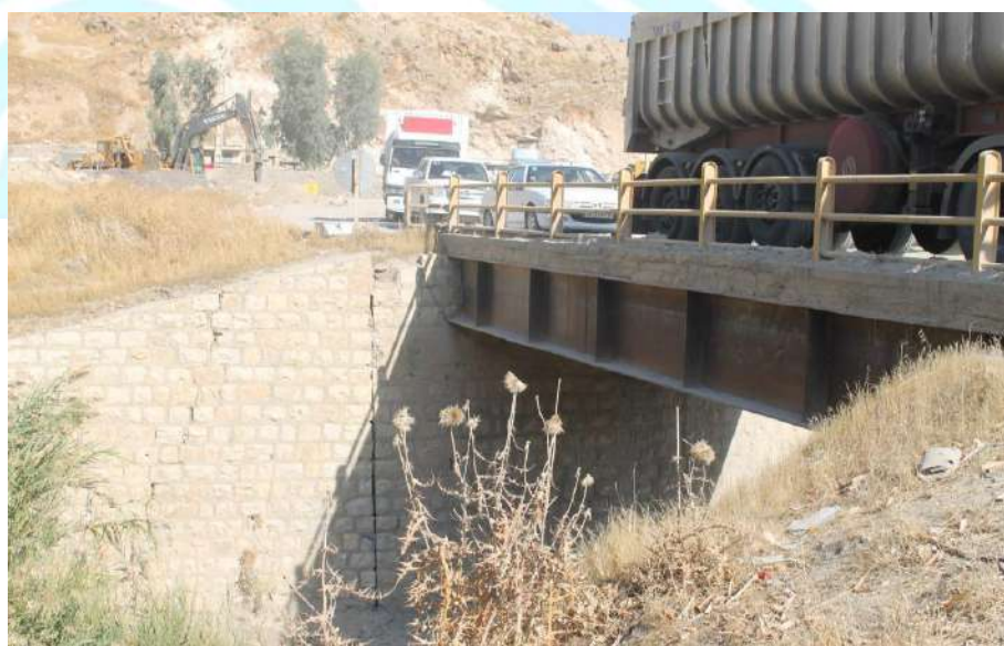
شکل ۱۰-۱- دیوار هادی اطراف کوله‌ها دچار ترک شده (بعد از روستای دارنیل از روستاهای ازگله)
