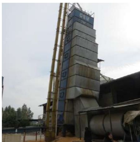
شکل ۱۱-۲۰- آسیب‌دیدگی پایه دستگاه ذرت خشک‌کنی ساخت شرکت عمران صنعت متعلق به شرکت ذرت خشک‌کنی
