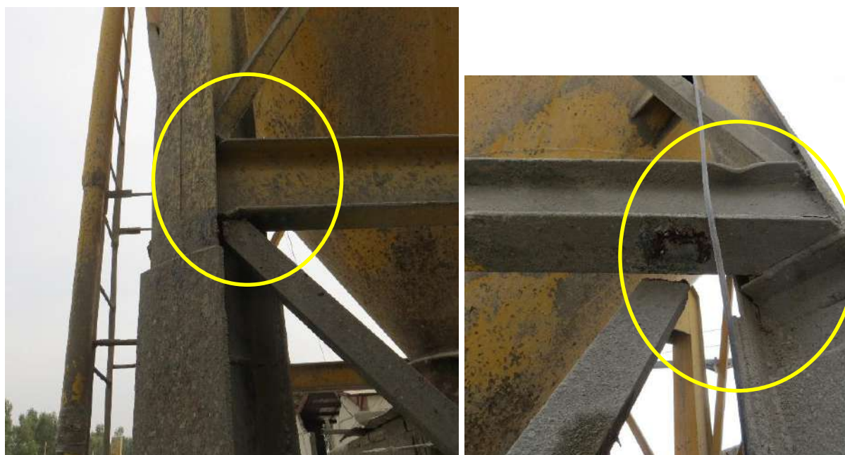
شکل ۱۱-۱۴ با وجود کمانش و شکستن جوش مهاربندها سیلوی سیمان قابل تقریباً آسیب ندیده و قابل استفاده است. (حدود ۷۰ درصد سیلو پر بوده و حدود ۳۰ درصد آن خالی است)
