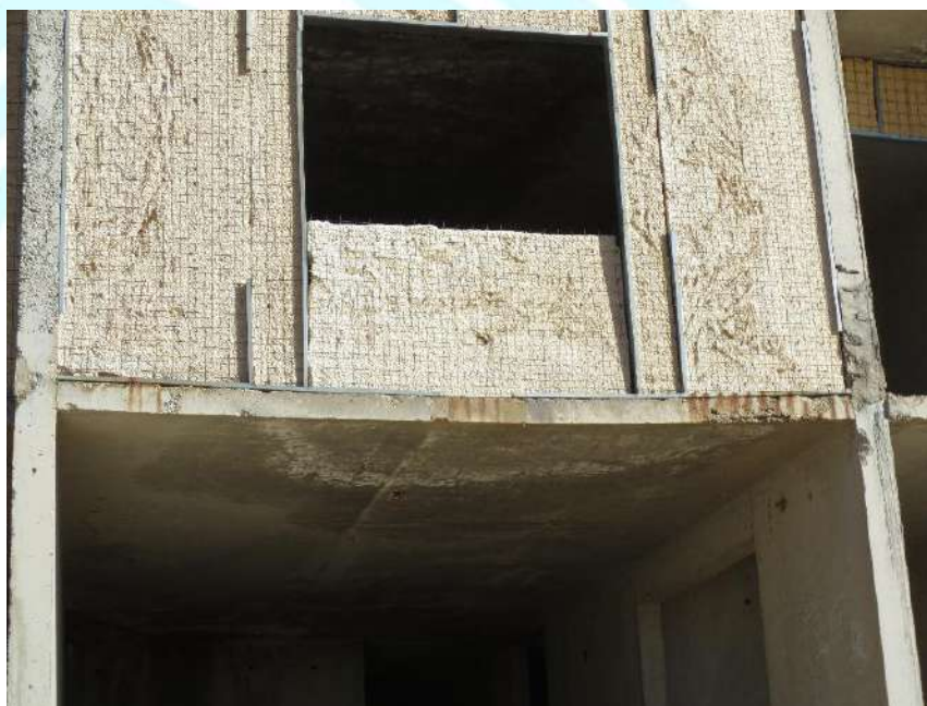
شکل ۸-۷۰- یکی از پانل‌های اجرا شده در این بلوک‌ها (خیز دال کاملاً محسوس است)
