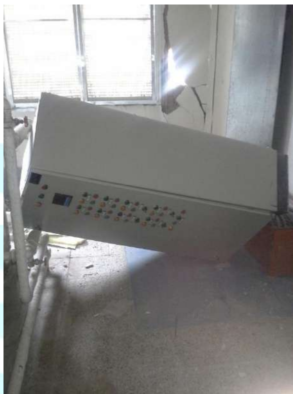
شکل ۱۲-۳۶- واژگونی تابلوی برق در بالاترین طبقه به دلیل عدم مهر مناسب
