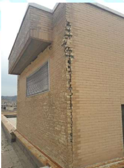
شکل ۱۲-۶۵- تخریب قسمتی از دیوار و نمای اتاق‌های هواساز بیمارستان
