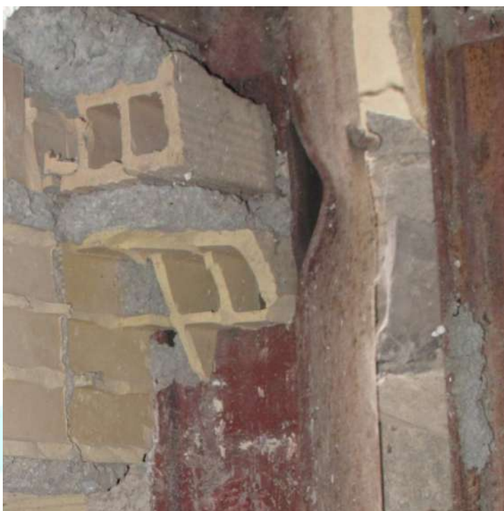
شکل ۸-۲۹- کمانش موضعی ورق در محل اتصال ستون بدلیل جوش ناپیوسته
