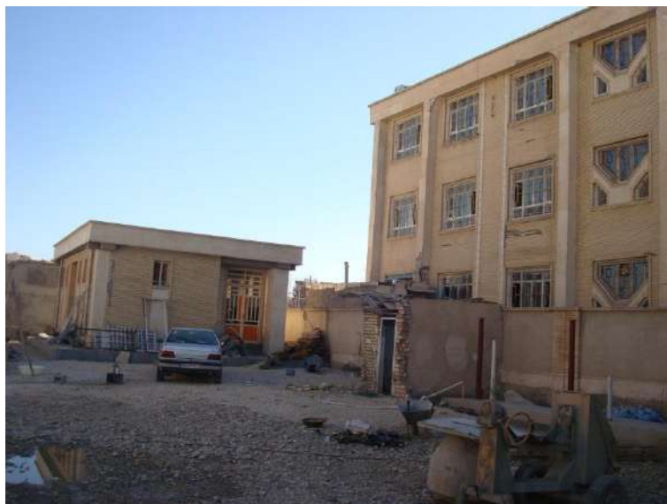
شکل ۱۳-۱۸- خسارت‌های ایجاد شده به ساختمان مدرسه
