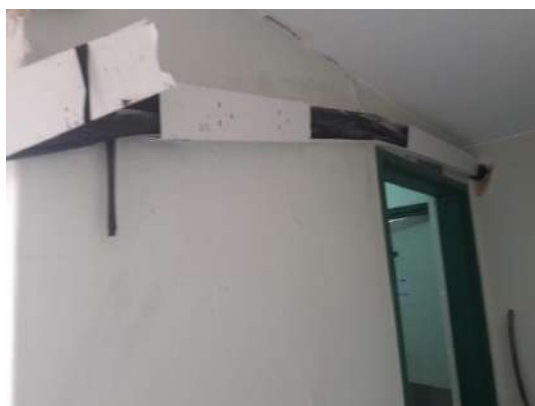
شکل ۱۲-۶۱- آسیب در مسیر و روکش کابل‌های برق
