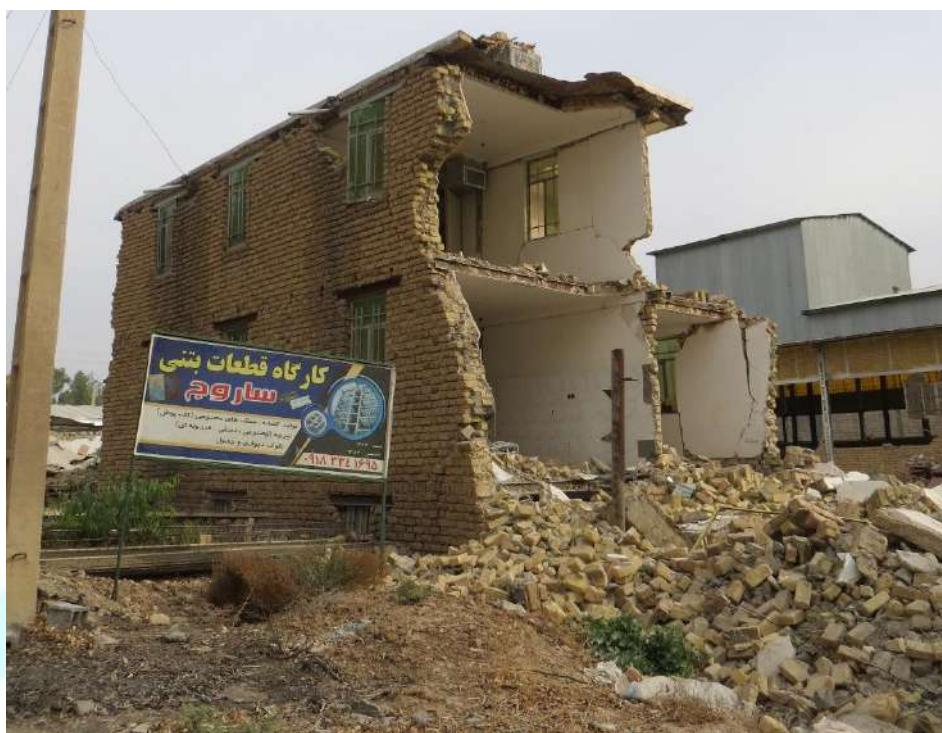
شکل ۱۱-۱۲- تخریب ساختمان آجری بدون کلاف‌بندی با سقف تاق ضربی - شرکت ساروج
