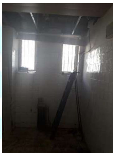
شکل ۱۲-۸۴- از کار افتادن بخش آزمایشگاه بیمارستان در اثر سقوط سقف کاذب و ترکیدن لوله
