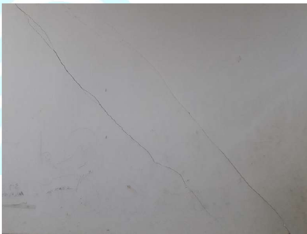
شکل ۱۲-۹۱- ترک‌خوردگی در دیوارهای اتاق‌ها
