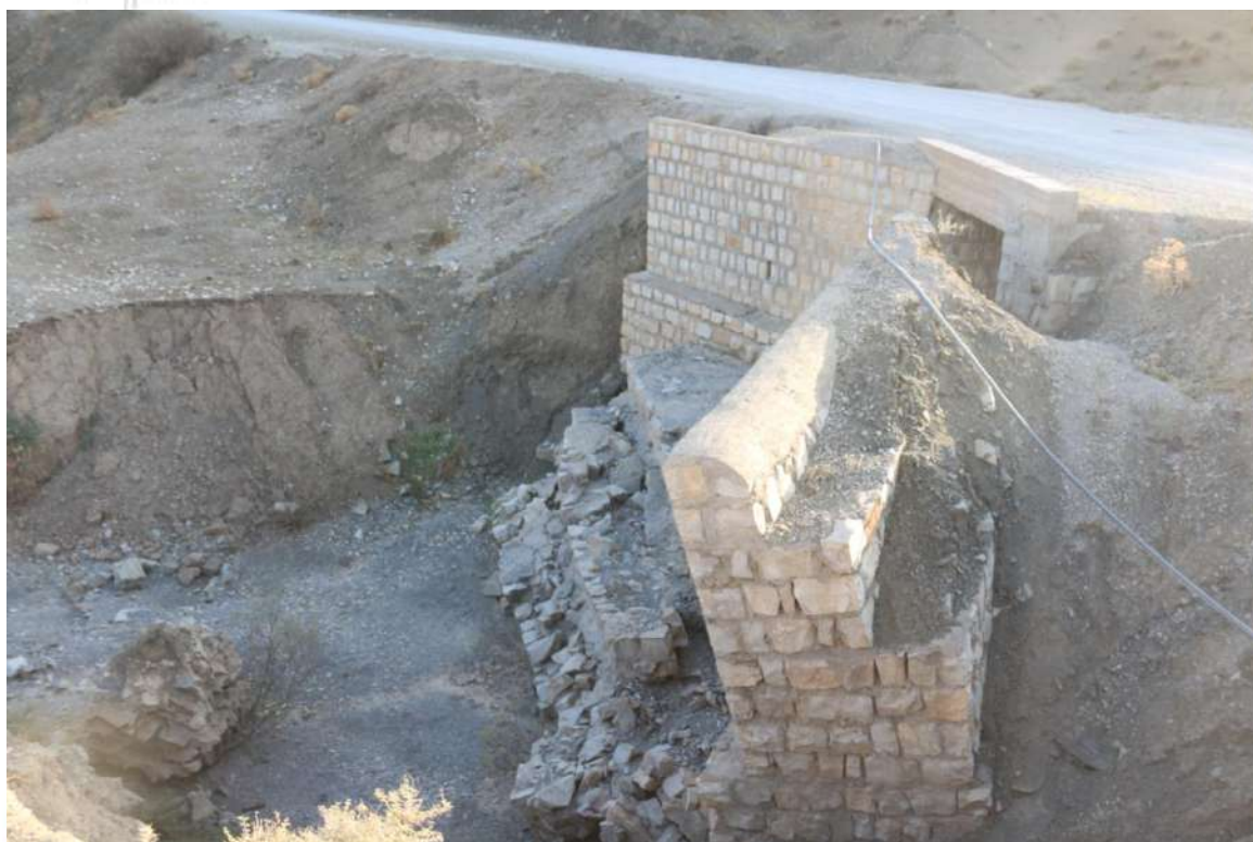
شکل ۱۰-۱۱- فروریختن کوله پل با دهانه ۴ متری در مسیر روستاهای کانی خنجر و نیمه کاره
