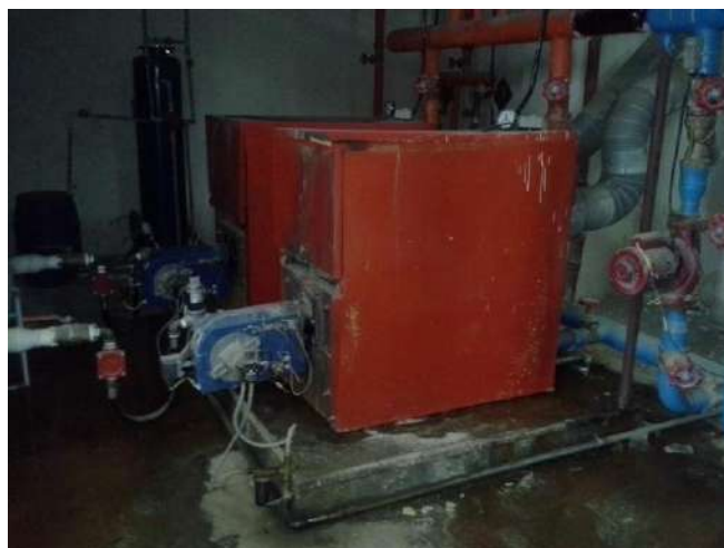
شکل ۱۲-۴۸- شکست و نشی لوله در موتورخانه
