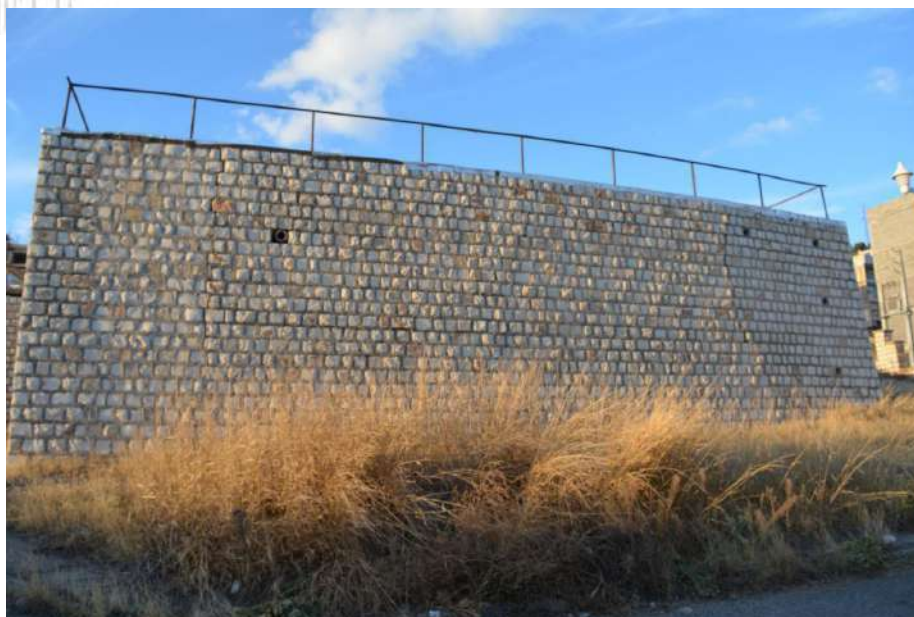
شکل ۱۲-۷۳- ترک‌خوردگی دیوار حصار منبع آب بیمارستان
