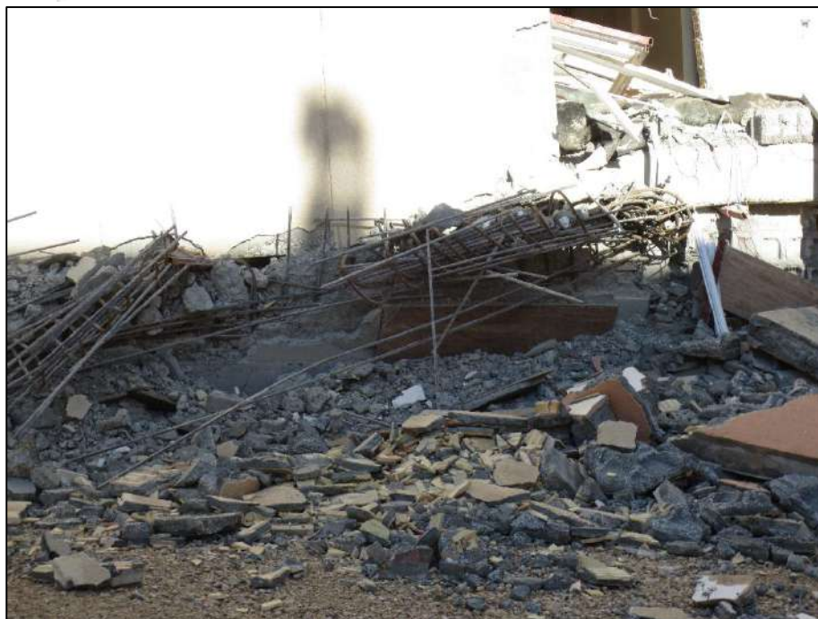
شکل ۸-۵۰- مهر نامناسب آرماتورهای افقی، مانع از مشارکت این آرماتورها در تحمل برش وارد به دیوار شده است.
