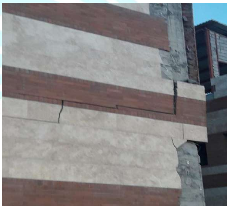
شکل ۱۲-۹۲- ترک‌خوردگی و فروریزش در نمای ساختمان در حال احداث
