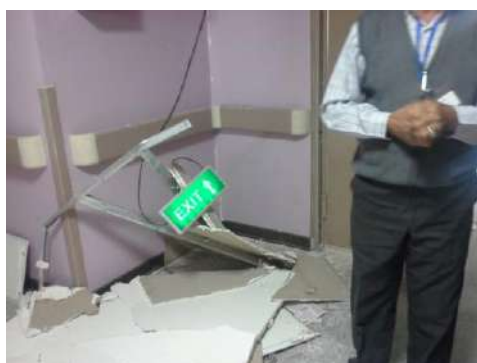
شکل ۱۲-۳۷- عدم رعایت جزئیات فنی در نصب تابلو و سقوط و انسداد مسیر
