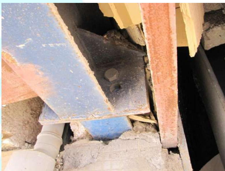
شکل ۸-۶۵- عدم اجرای پیچ و حذف آن در بعضی اتصالات
