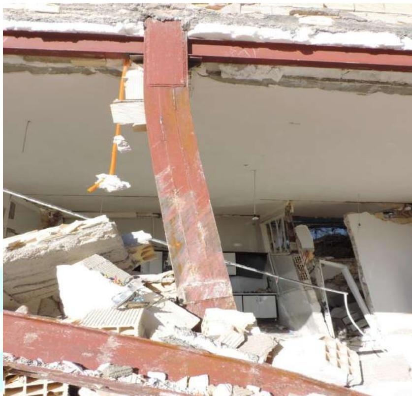
شکل ۹-۱۹- دریافت زیاد در ستون‌های طبقه همکف در ساختمان شاهد
