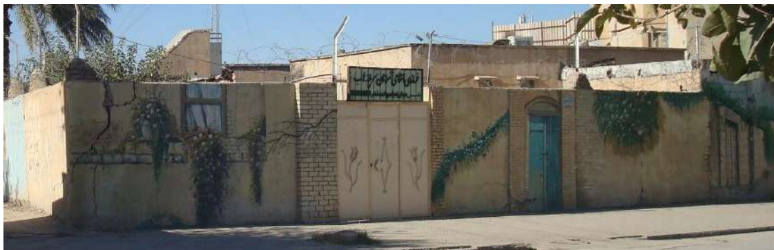
شکل ۷-۱۴- خرابی دیوار محوطه ساختمان نیروی انتظامی سرپل ذهاب
