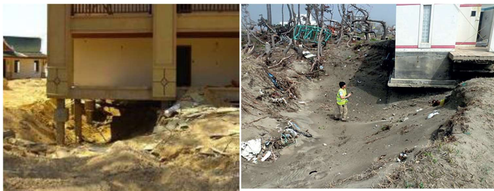
شکل ت-۱۵-۱۲ تصاویری از آب‌شستگی موضعی
